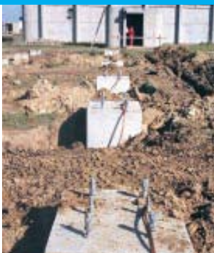
Osim glavnog uzemljenja, pripremljeni su spojevi za uzemljenje čelične konstrukcije nosača sabirnica i aparata
