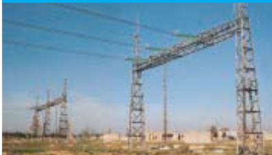
DV 400 kV Ernestinovo-Žerjavinec i Ernestinovo-Ugljevik već su spojeni na portale u trafostanici
