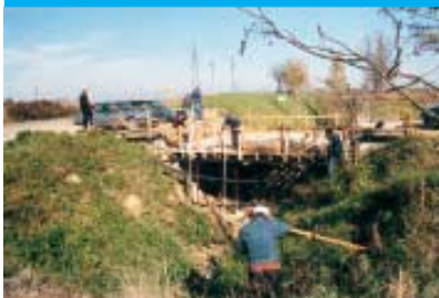
Stručnjaci IGH obavljaju posljednju provjeru novog pristupnog mosta ispred trafostanice prije betoniranja
