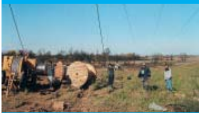
Još zemno uže i obnova zateznog polja od stupa 306 do 311 DV 400 kV Ernestinovo-Ugljevik bit će dovršena
