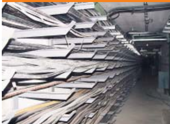
Da bi strojnica normalno funkcionirala potrebni su snopovi i snopovi kabela
