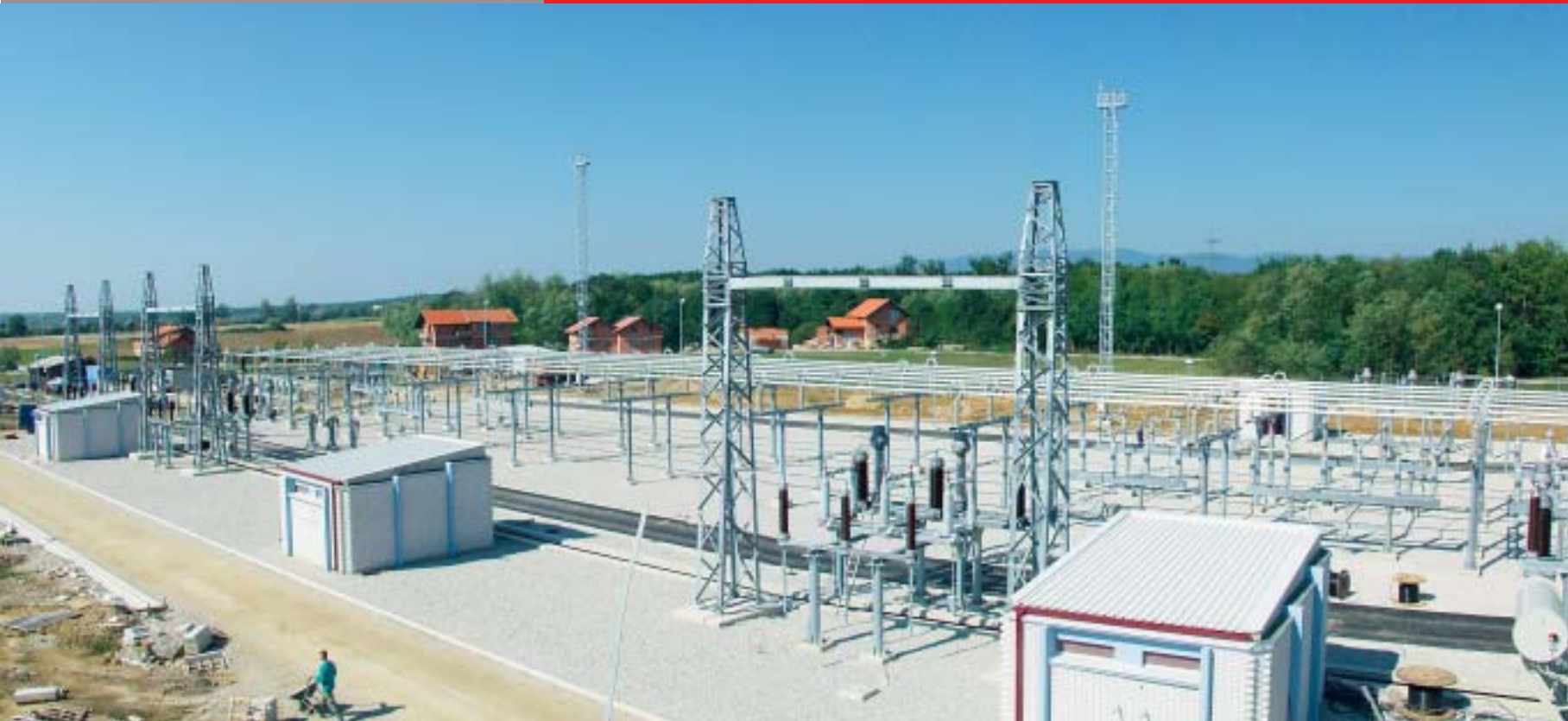
Pogled na RP 110 kV
