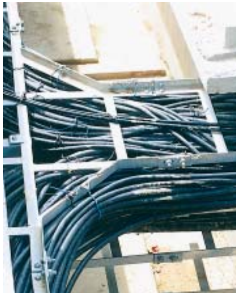
Šuma kabela u kabelskom kanalu
