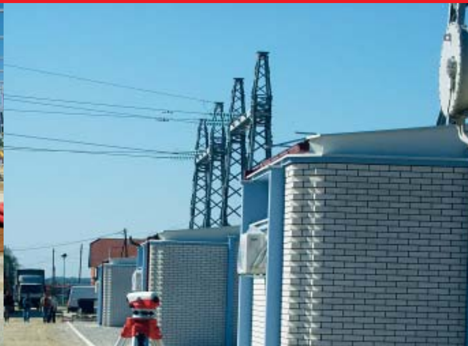
DV vodiči spojeni su na portale DV 110 kV Resnik i DV 110 kV Dugo Selo
