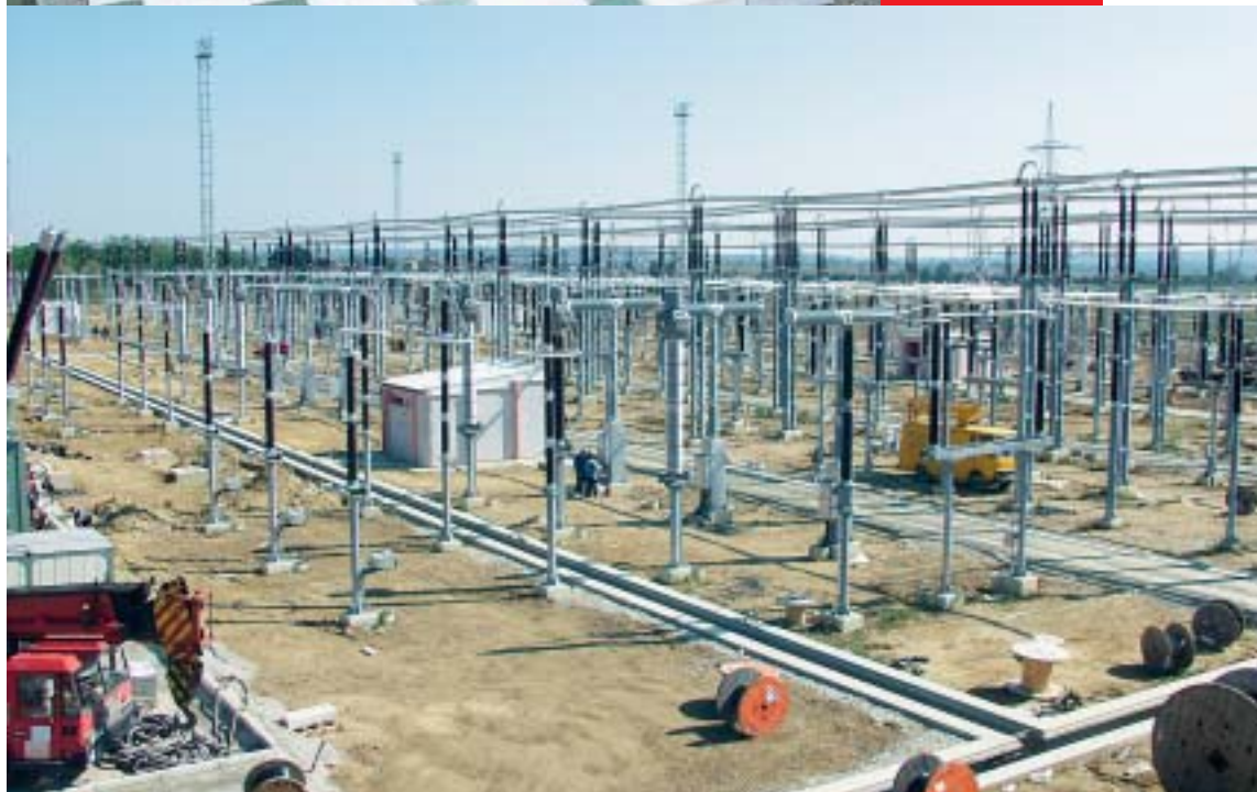
Pogled na RP 400 kV, sredinom rujna
