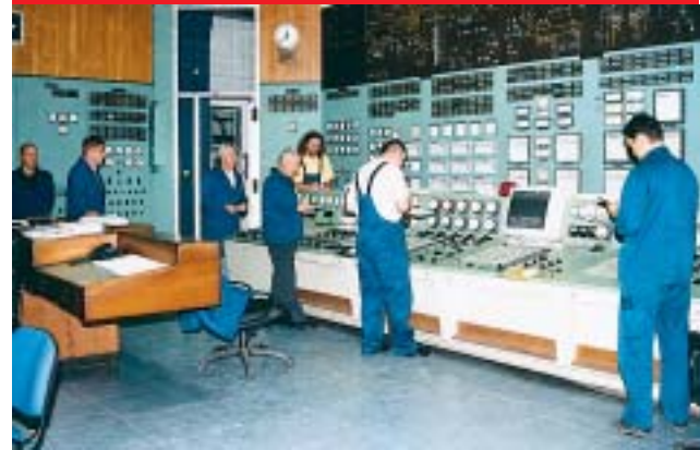
U upravljačkoj prostoriji strojarstva posadu s glavnim uklopničarom čine: Josip Jerkić, smjenovođa, Josip Kusturić, blokovođa, Davorin Malić, glavni uklopničar, Davor Krajačić i Marijan Perak, strojari kotla, te Krešimir Gregurić, pomoćnik strojara kotla
