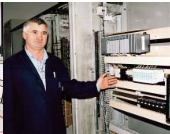
Poslovođa Nikola Valčić uz novu signalizaciju
