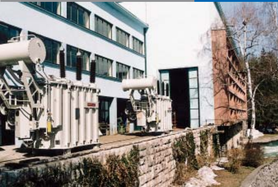
Novi transformatori čekaju montažu
