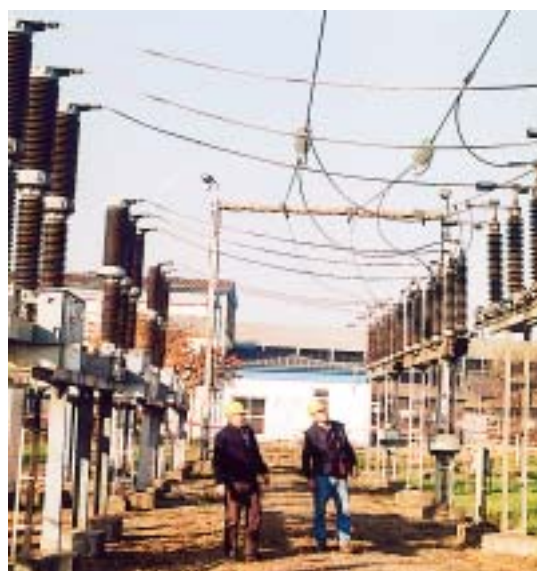
Visokonaponsko 110 kV postrojenje u TS Požega 2 (u pozadini se vidi dograđeni objekt) - rekonstrukcija se provodi etapno, sukladno pristizanju dozvola i financijskih sredstava
