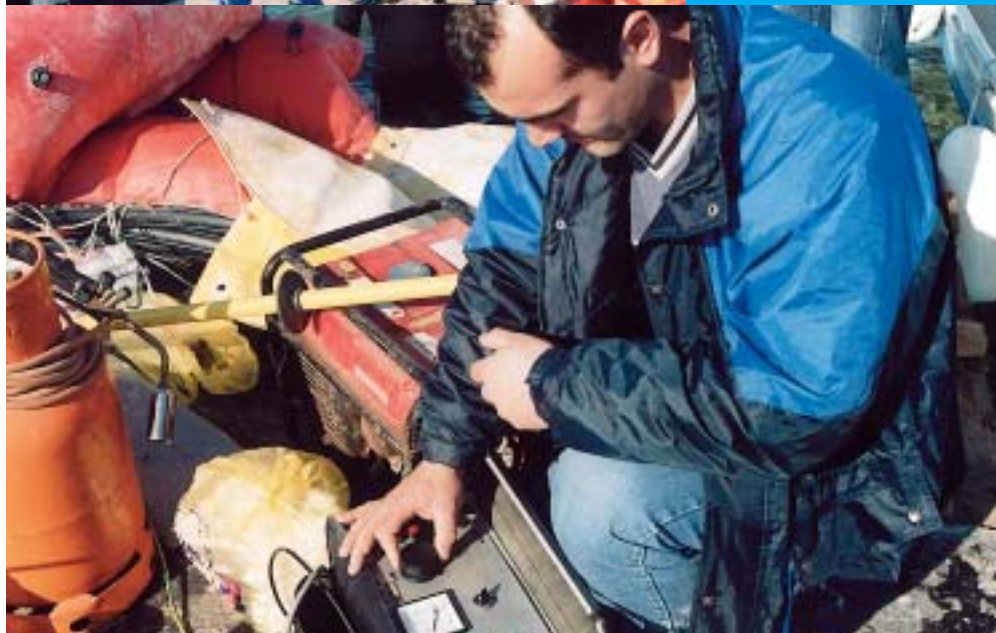
Josip Santini iz zadarskog Odsjeka kabelske mreže ispitao je kabel s kopnene strane
