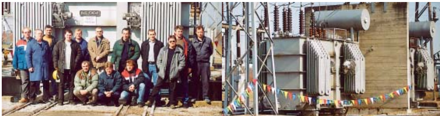
Ekipi PrP Osijek trebalo je samo deset dana za transport i montažu transformatora u TS 110/35 Valpovo
