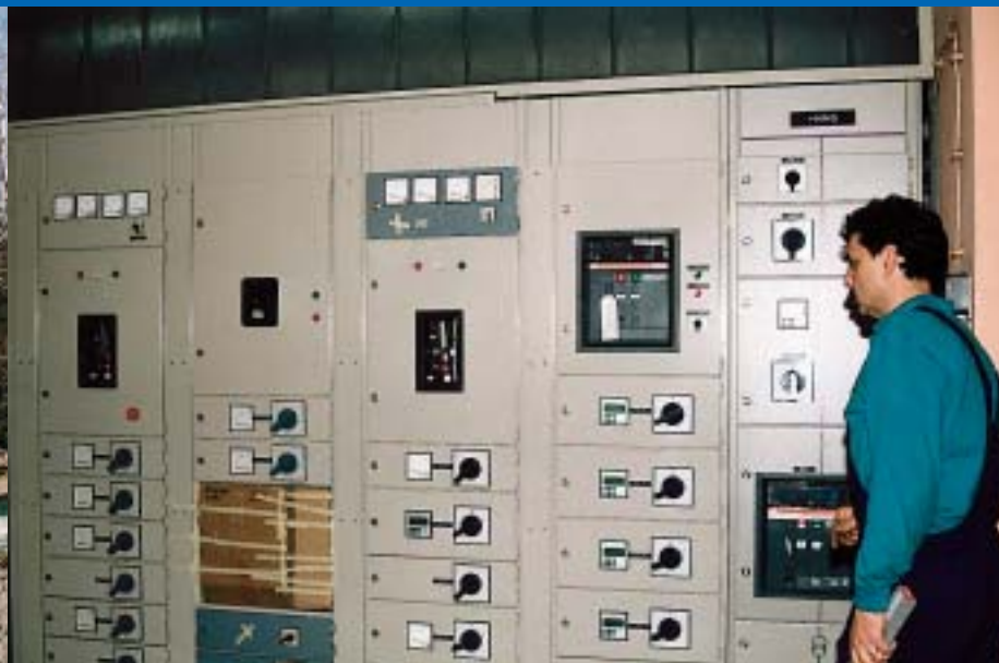
Rekonstruirana se i ploča vlastitog napajanja
