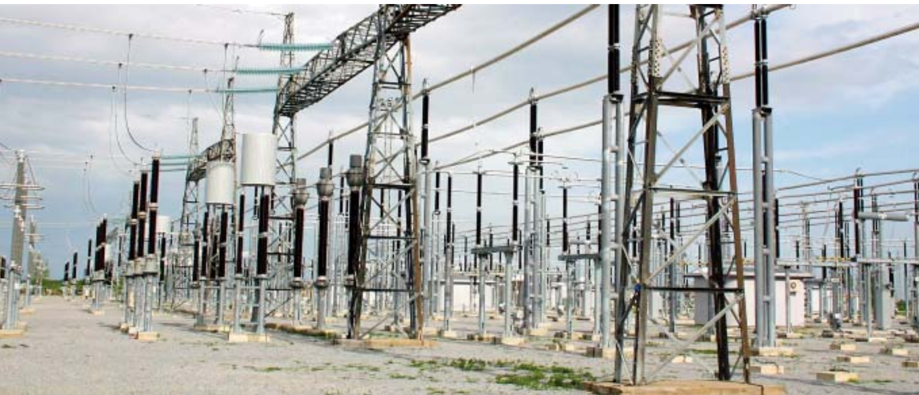
Trafostanica Ernestinovo - priključak na 400 kV dalekovod
