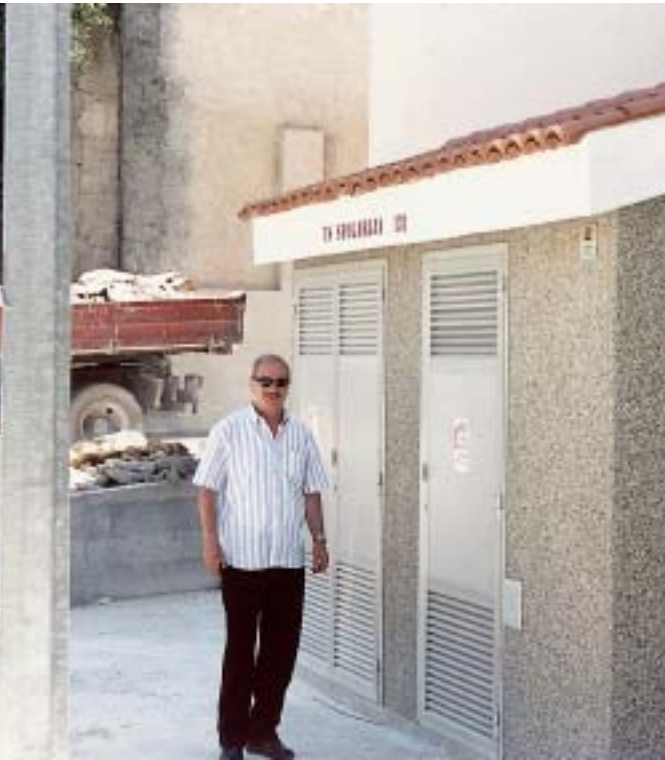
Rukovoditelj Pogona Makarska Miro Radić ispred nove gradske transformatorske stanice, koja doprinosi boljim naponskim okolnostima potrošača u središtu Makarske
