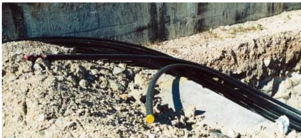
U zemlju se položilo 12 kabelskih žila
