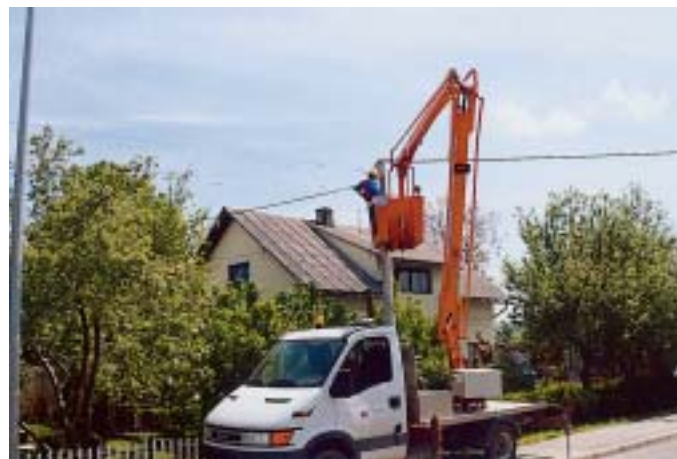
...VKV monter- majstor Damir Mateša na rekonstrukciji niskonaponske mreže u ogulinskom naselju Galge 2
