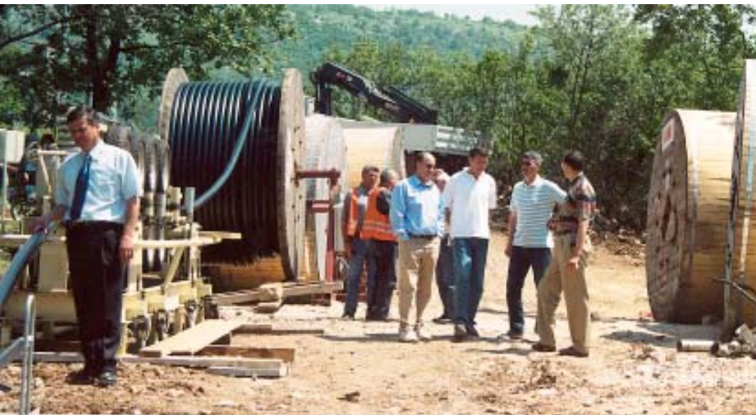
Čelnici Službe za izgradnju (SIU) i usluge Elektrodalmacije Split pri pregledu kabske trase u Sušaku
