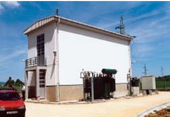
Rekonstrukcija TS 35/20/10 kV Oštarije bila je nužna radi puštanja u promet nove autoceste od Bosiljeva do Male Kapele
