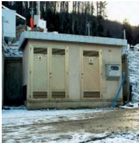
Trafostanica za priključak privremenih objekata - šatora, tribina, kabina za reportere
