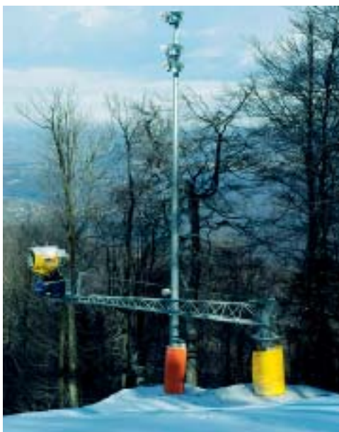
Zahvaljujući Elektri Zagreb, snježni topovi i rasvjeta uz stazu funkcionirali su besprijekorno
