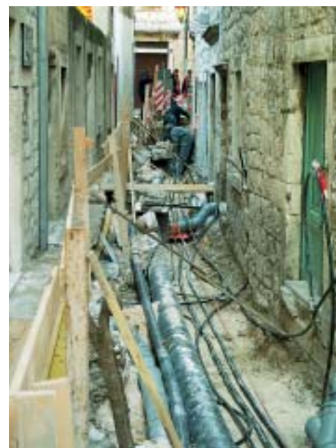
Neugodna iznenađenja u kanalima - dotrajale kanalizacijske instalacije ili slijevanja crnih jama ...
