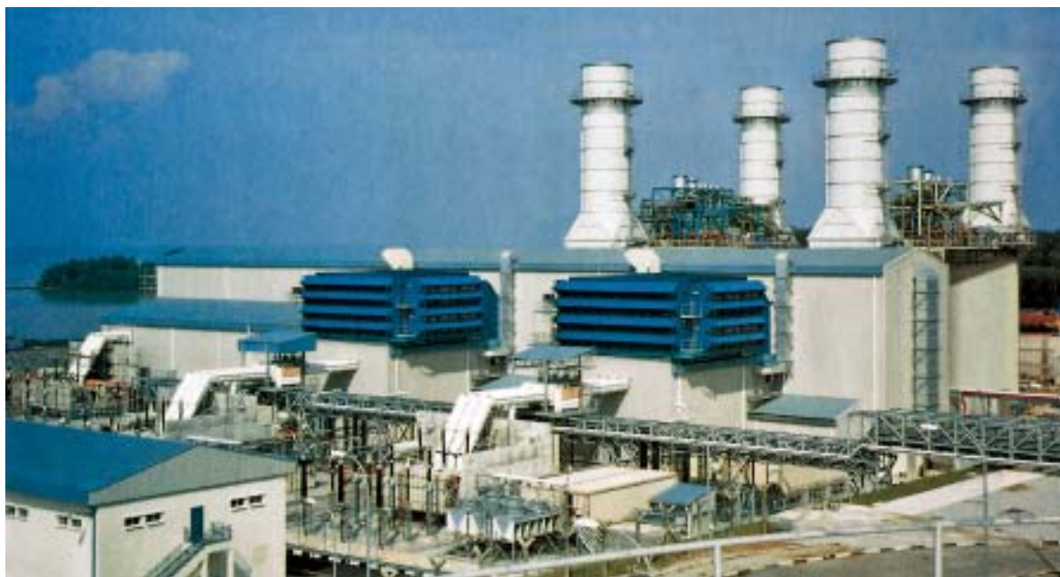
Kombi elektrana 710 MW Panglima na lokaciji Teluk Gong u Maleziji s dvije plinske turbine V94.A3
