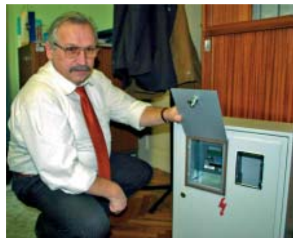
Miroslav Radko, rukovoditelj Odjela za odnose s potrošačima DP Elektroslavonije, uz ormarić s ugrađenim samonaplatnim brojilom koji čeka suglasnost Zavoda za sigurnost
