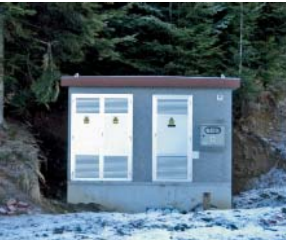
Nova Trafostanica 10/20/0,4 kV na Sljemenu
