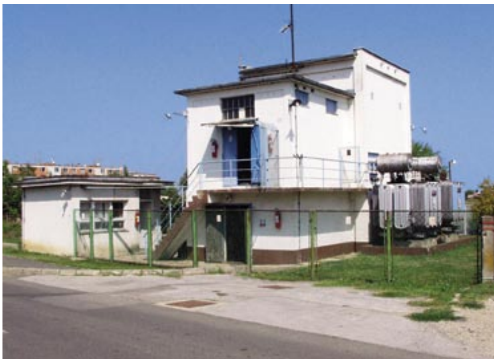
Postojeća TS 35/20/10/ kV Sisak 1, iz koje se napaja približno 40 posto potrošača Siska
