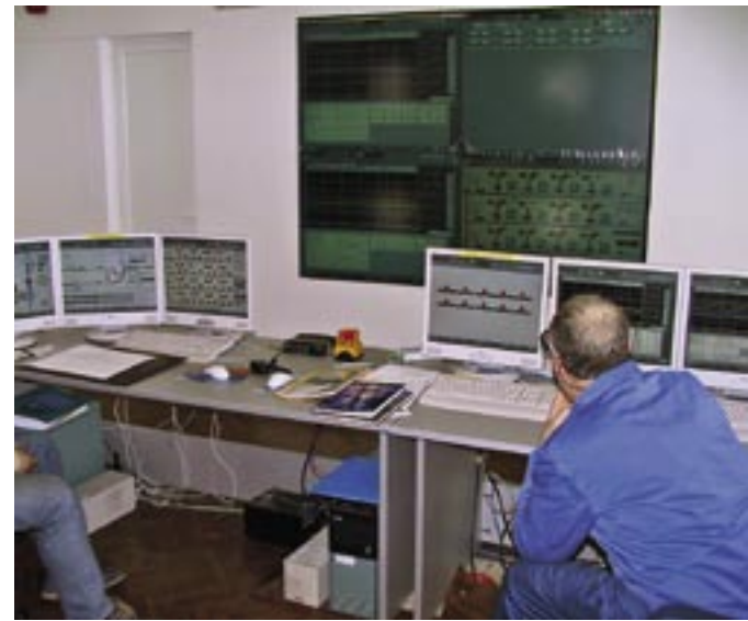
Novi izgled pulta u upravljačkoj sobi iz koje se računalom upravlja sustavom
