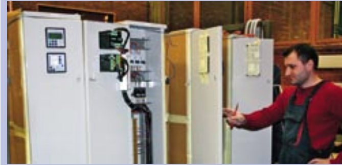
Poslovi rekonstrukcije pomoćnog postrojenja i uvođenja u SDV-a TS 35/10 kV Bebrina, DP Elektra Slavonski Brod
