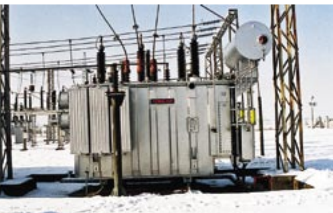
Novi transformator 40 MVA višestruke koristi
