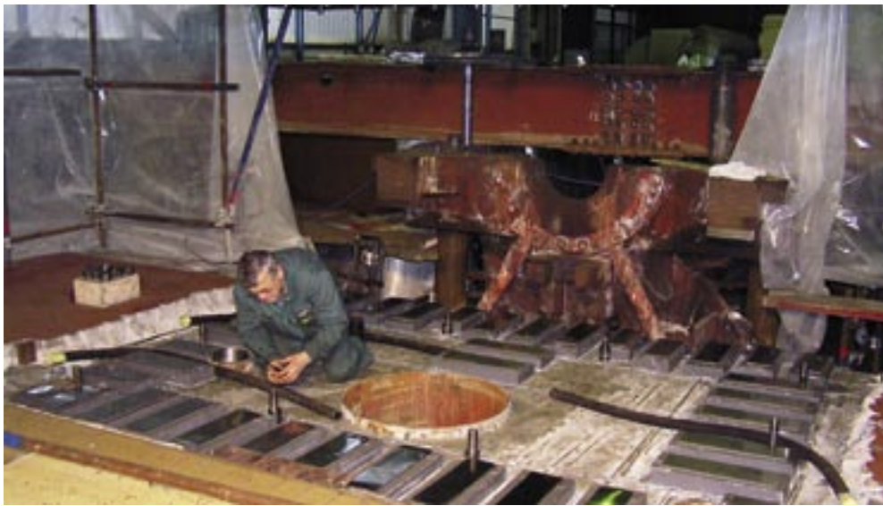
Sanacija prednjeg ležajnog postolja (prednje ploče) po kojemu klizi kućište turbine, nužni veliki zahvat prema opsegu i složenosti
