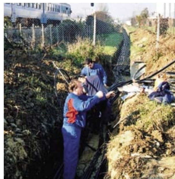
Polaganje srednjenaponskih kabela u požeškoj industrijskoj zoni uz željezničku prugu Požega-Pleternica-Nova Kapela
