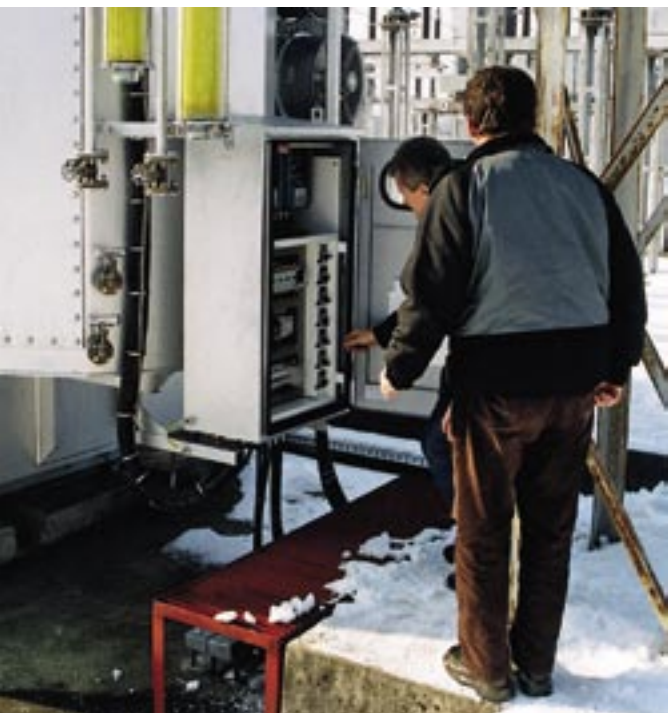
Proveru regulacije na novom transformatoru obavili su voditelj interventne službe Zvonimir Štabi i interventni uklopničar Petar Žitnjak
