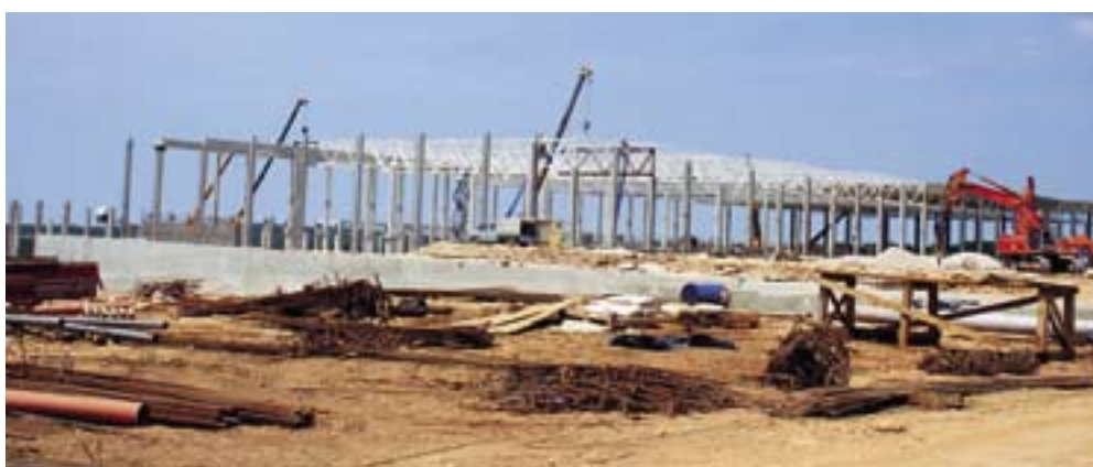
Gradilište nove tvornice duhana u industrijskoj zoni Kanfanar, još jednog velikog kupca električne energije
