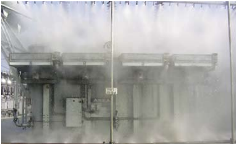
Simulacija stvarnog događaja - prskanje transformatora jakim mlazovima vode
