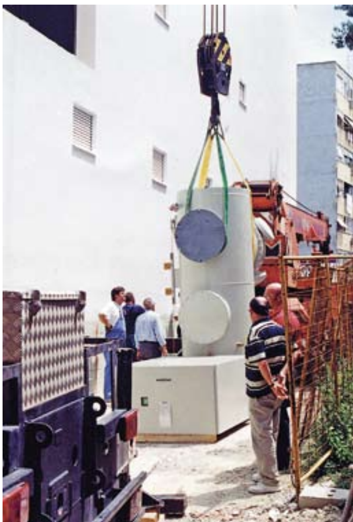
Prvi korak: dogovor kako podignuti ovaj, više od pet tona teški, dio sustava Trafostanice Dobri
