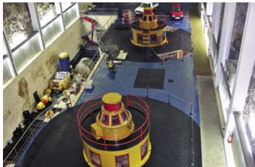
Dok se završava remont agregata B, agregat A radi maksimalnom snagom od 105 MW
