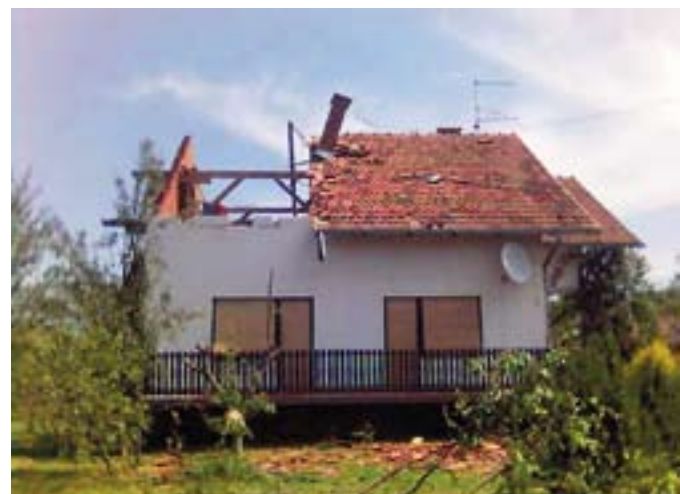
...kuća bez dijela krova
