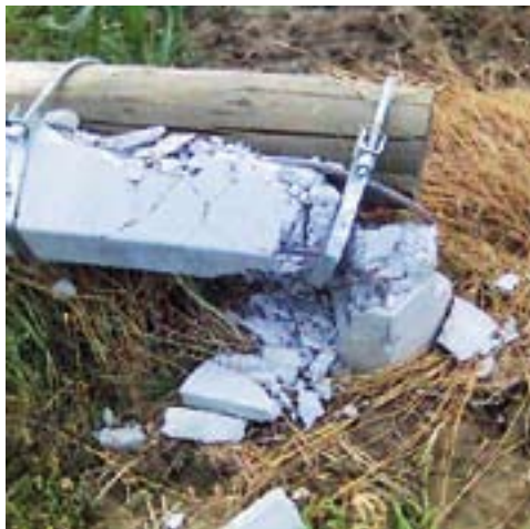
Popucali nogari stupa na trasi DV 10 kV u selu Orlovac, a zanimljivo je da je vjetar prizemljio sve stupove na toj trasi i svima su popucali nogari stupova dalekovoda koji je izgrađen prije tri godine
