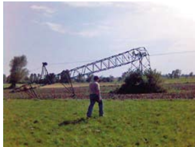
Čelično-rešetkasti stup 35 kV Veliki Grđevac-Veliki Zdenci (jedan od dva srušena) - u neprirodnom položaju: s nosom na tlu
