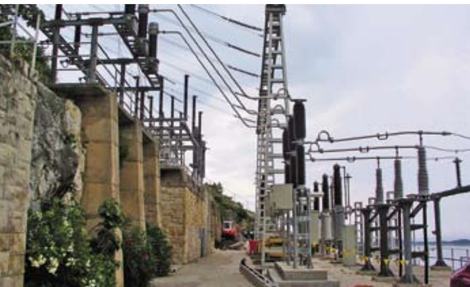
Tijekom remonta obavljena je i zamjena dotrajale opreme u rasklopnom postrojenju 220 kV
