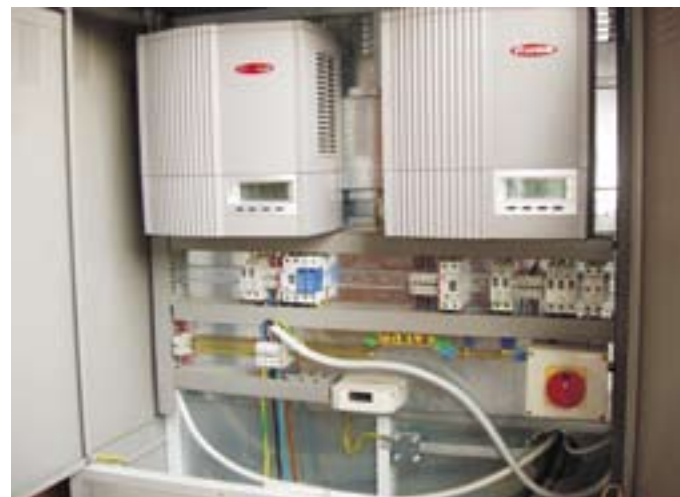
Izmjenjivači (inverteri) u razvodnoj kutiji
