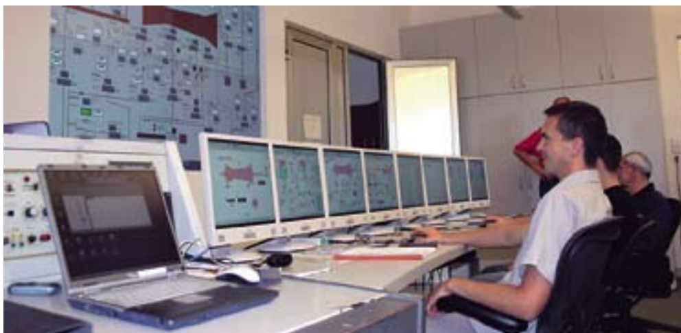
Proces vođenja Bloka 45 MW u TE-TO Osijek preseljen na zaslone monitora
