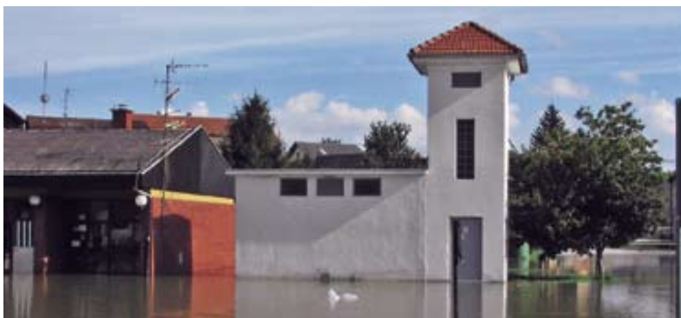
Transformatorska stanica Mursko Središće u vodi
