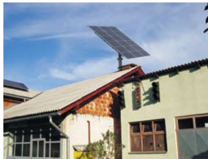
Sunčevi i toplinski kolektori na krovu
