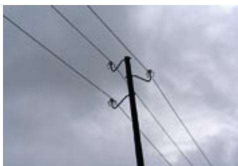
Premda dalekovod kojeg su 1927. godine izgradili Talijani dobro funkcionira (bez ikakvih dosadašnjih zamjena), za prelazak na 20 kV napon potrebno je zamijeniti cjelokupnu izolaciju
