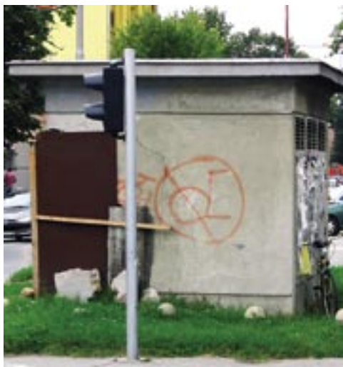
Oštećena trafostanica, privremeno zaštićena daskama
