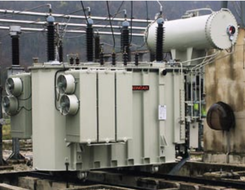
Novi transformator, snage 40 MVA, u TS 110/35 kV Sinj zamijenio je dva transformatora snage 16 MVA koji su, ako je jedan od njih ispao iz pogona, ostavljali Sinj u mraku
