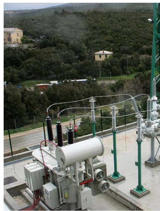
Prva jednostavna TS 110/6 kV u Hrvatskoj u krugu Tvornice cementa trafostanica, koja je uz to pouzdana i jeftina
