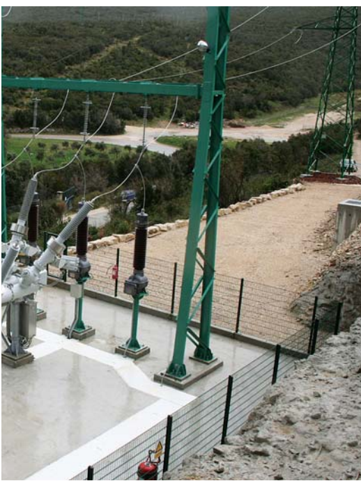
Koromačno: ovo je cijelo vanjsko postrojenje, prava mini
