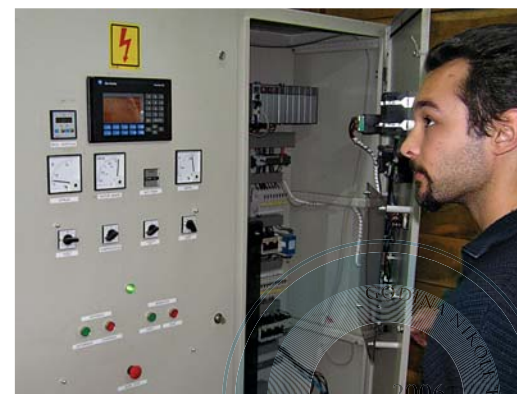
Ormar s regulacijskom opremom u mHE Mataković studentu je bio zanimljiv
