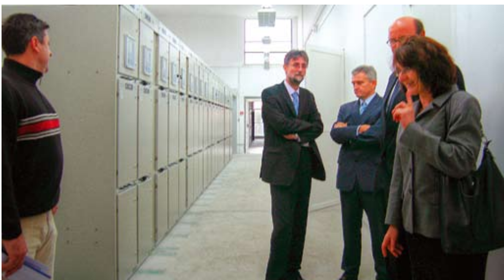
Direktor HEP ODS-a M. Jurković obilazi novo postrojenje TS Biograd
