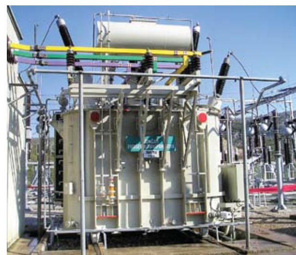
...transformator je bio spreman za probni pogon
