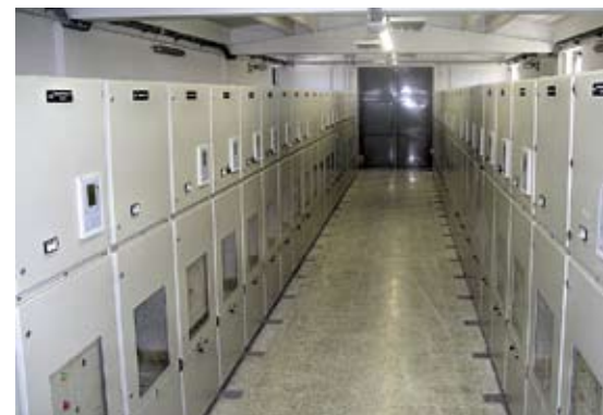
Sredjenaponsko postrojenje TS Siscia
