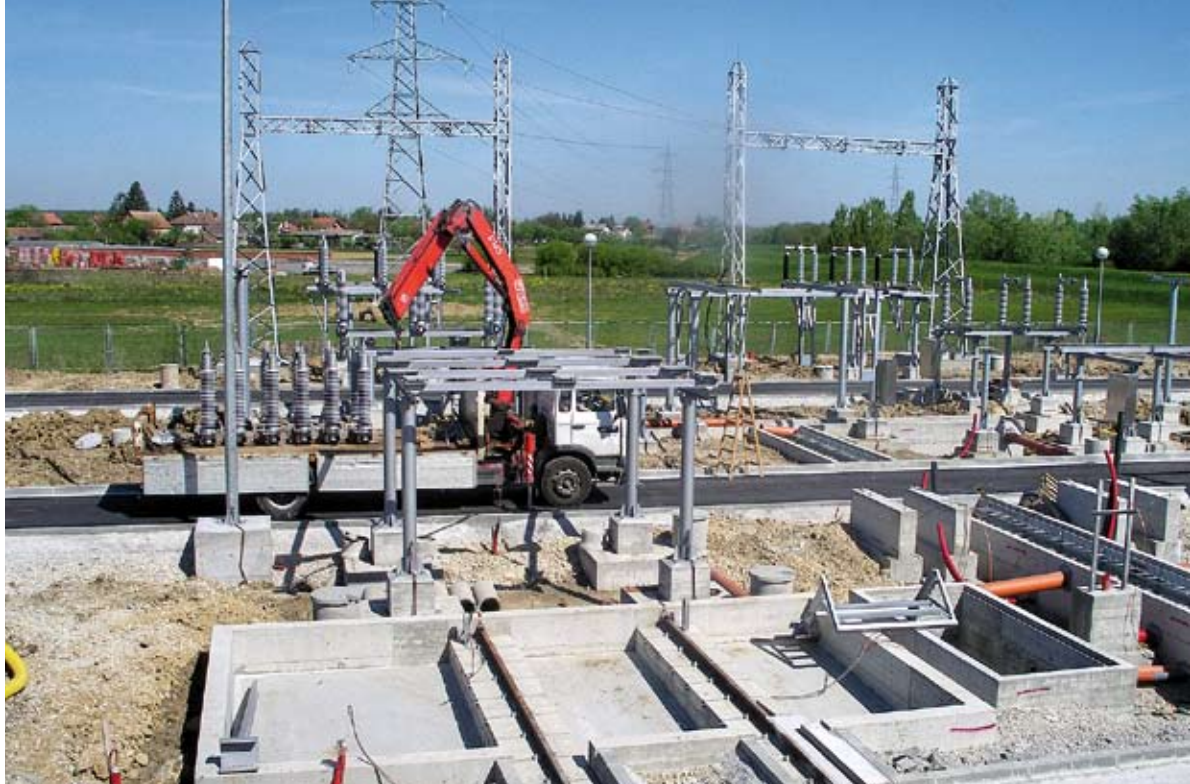
Pogled na 110 kV dio i postolja transformatora
