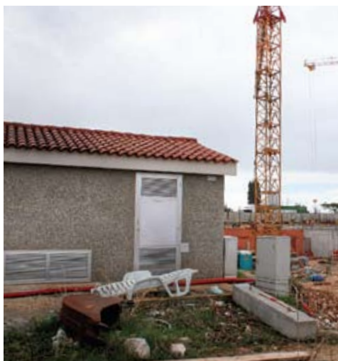
Postojeća trafostanica na gradilištu i gradilište luksuznog hotela
