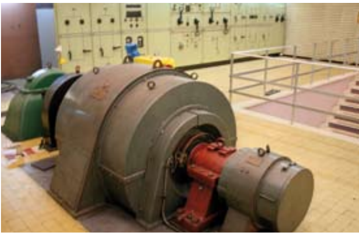
Kućni generator koji čeka montažu turbinske regulacije
