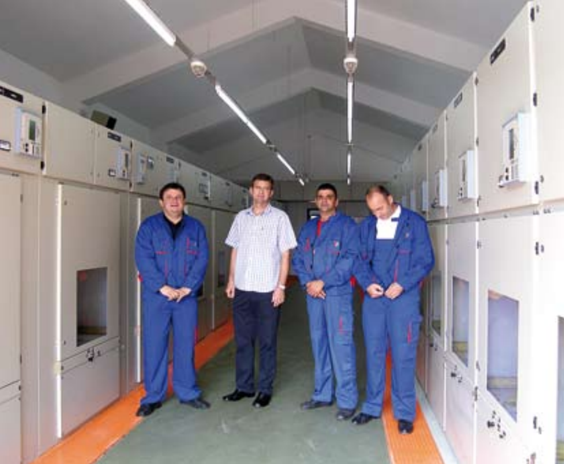
Novom TS 35/10(20) kV zadovoljni su i uklopničari i šefovi
