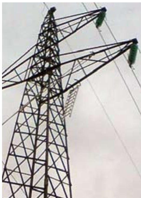
Ljestve obješene na konzolu stupa broj 26 dalekovoda 110 kV Slavonski Brod – Požega, s kojih je pao Igor Korman, a ovdje su pomoćno užje i kolotura
