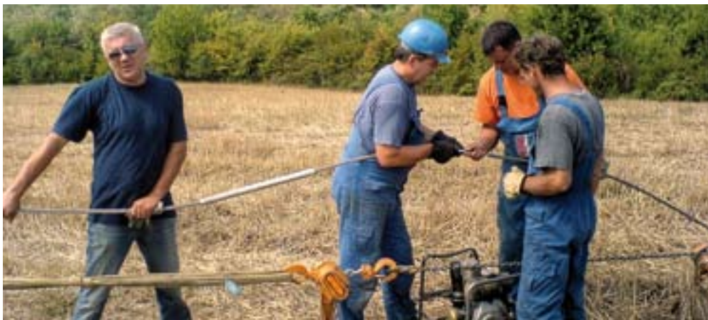
Sat prije nezgode, članovi ekipe PrP Osijek pri pripremi mjesta rada i organizaciji zahvata ni slutili nisu da će taj radni dan završiti tragično (na fotografiji nije Igor Korman)
