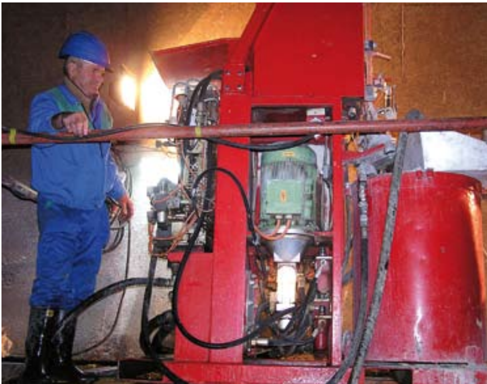
Injekcijska stanica u lijevom dovodnom tunelu i...
