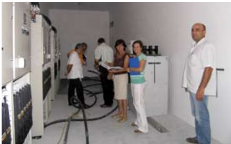
Pri prvom internom tehničkom pregledu, ekipa Elektrodalmacije bila je u punom sastavu
