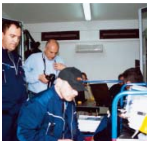
U relejnoj kućici 403 stručnjaci Instituta za elektroprivredu i energetiku i PrP-a provjeravaju funkcionalnost sustava relejne zaštite i rasklopnih aparata pri pokusima kratkog spoja
