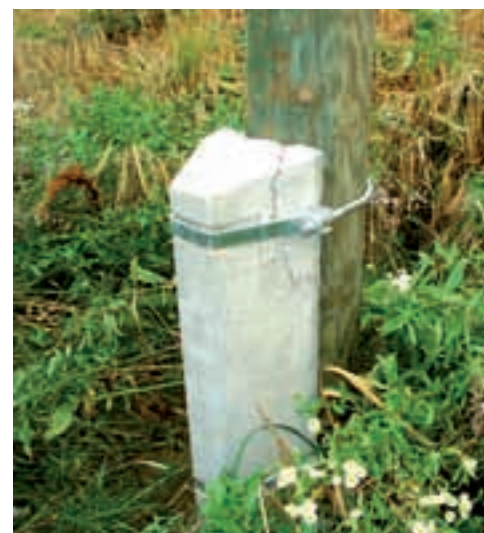
Popucala su i betonska ojačanja stupova na visokonaponskoj mreži
