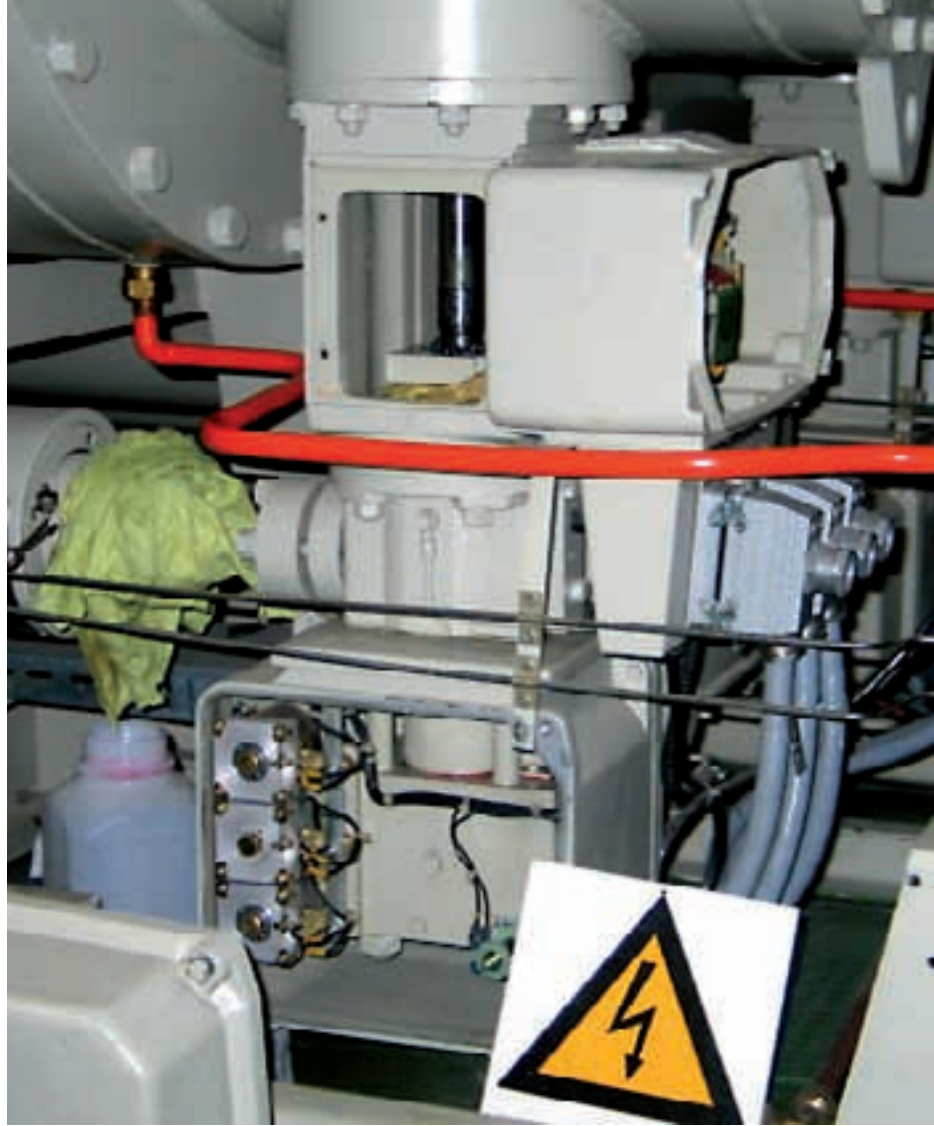
Generatorski prekidač – priprema za ispitivanje ventila sigurnosti i spremnika
