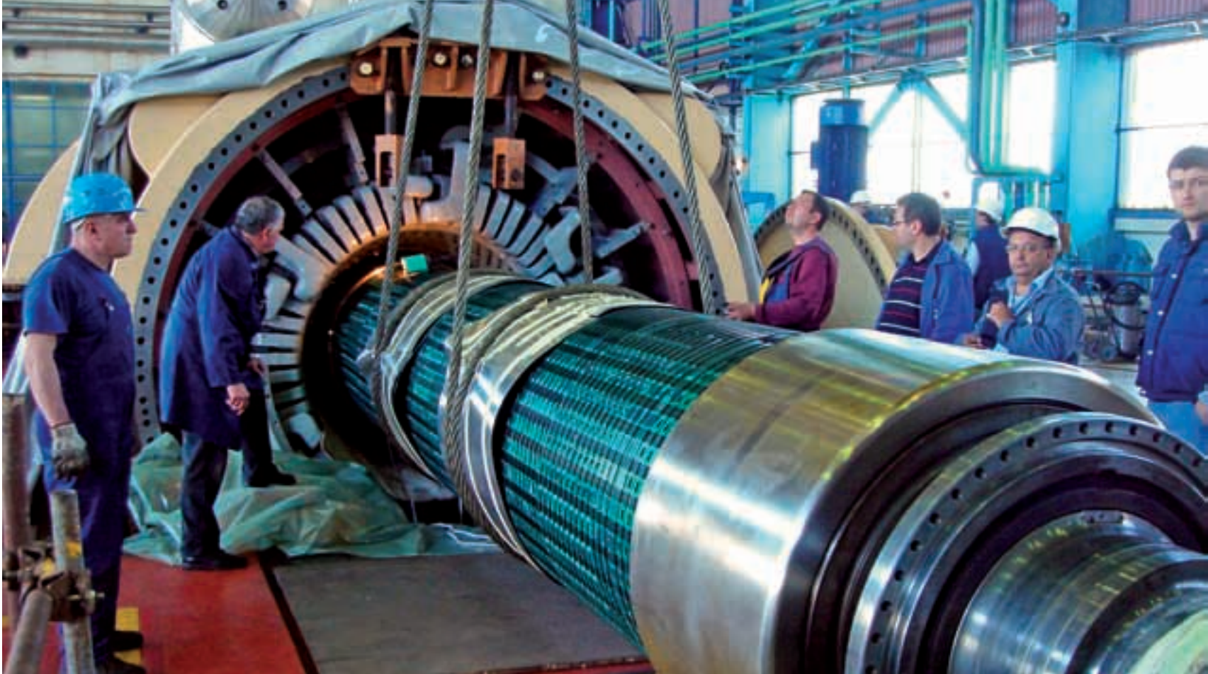
Uvlačenje rotora generatora nakon revizije
