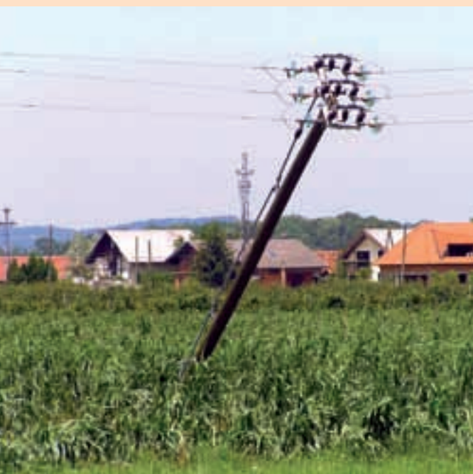
Uništen je i 10 kV rastavljač Vratno Donje
