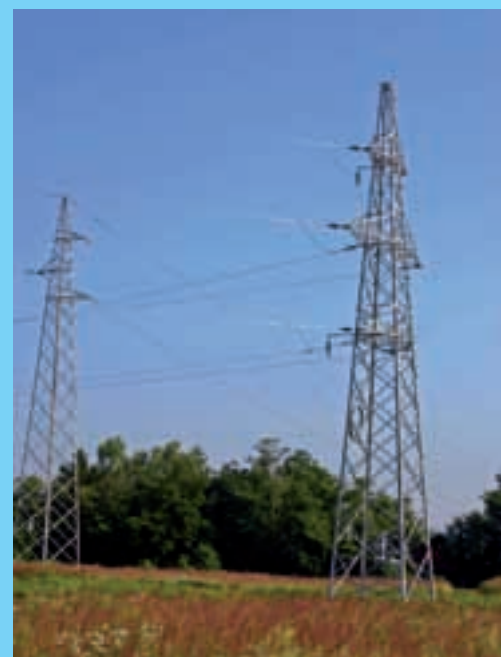
Stup 17A (desno) dalekovoda TS Osijek 1 – TS Orlovnjak, kojim je TS Ernestinovo od sada povezana s TS Osijek 1 i TS Osijek 2
