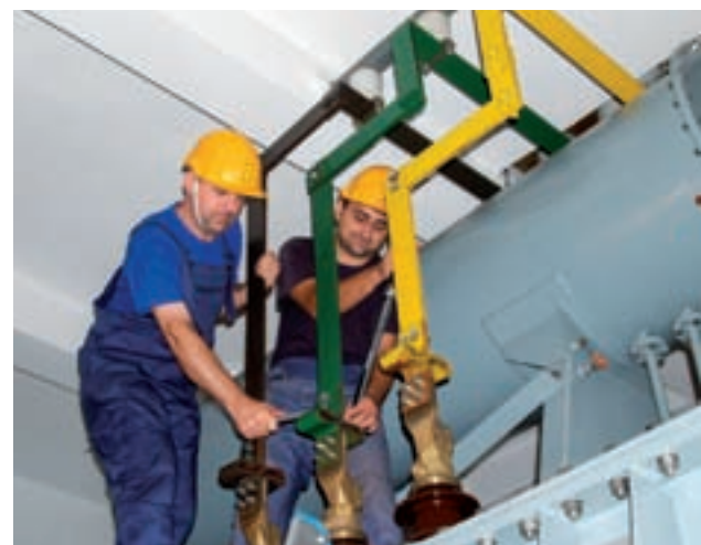
Zlatko Citković i Davor Valković odspajaju izvođe blok-transformatora
