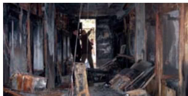
Unutrašnjost izgorjelog rasklopnog postrojenja 35 kV u TS 110/35 kV Komolac i
