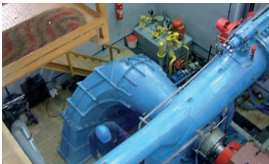
Dok je ABM u remontu, vodu prema potrebi preuzimaju agregati s početka prošlog stoljeća
