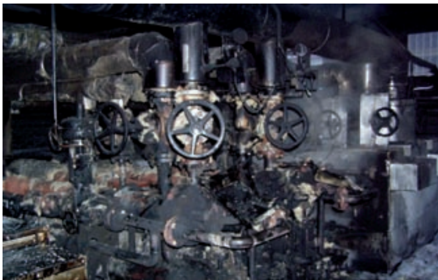
Unutrašnjost dogrijačke postaje mazuta u TE-TO Zagreb nakon požara, koji je brzo lokaliziran, a pravodobno je spriječeno onečišćenje okoliša razlivenim mazutom
