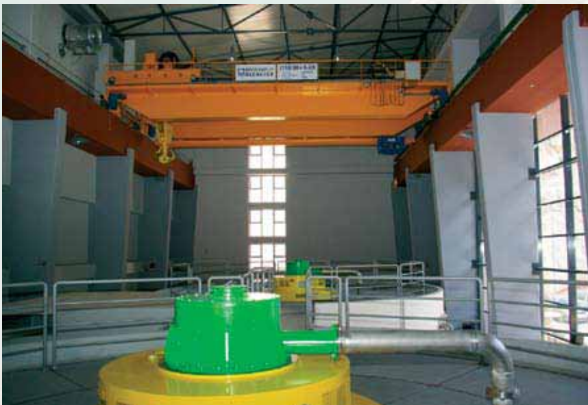
Generatori i dizalica za potrebe remonta
