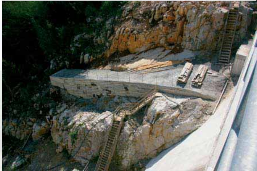
Zabrtvljenjem obilaznog tunela, Dobra će se preusmjeriti u temeljni ispušt te će biti omogućeno punjenje akumulacijskog jezera
