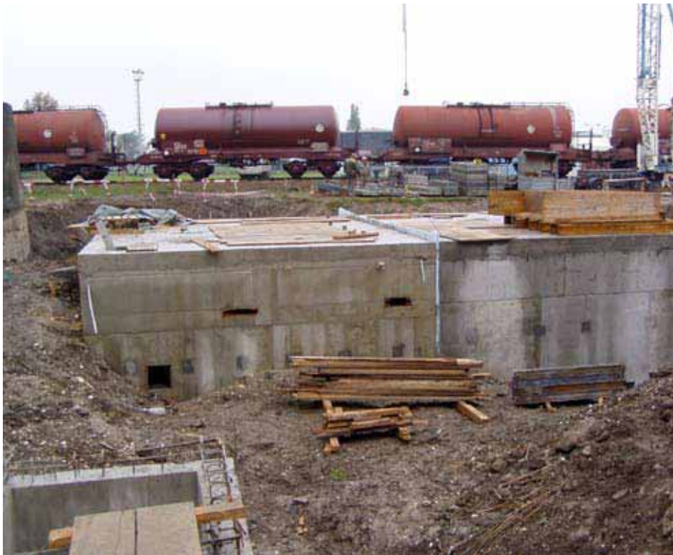
Građevinski radovi na sabirnoj crpnoj stanici za odvodnju u glavni odvodni kolektor
