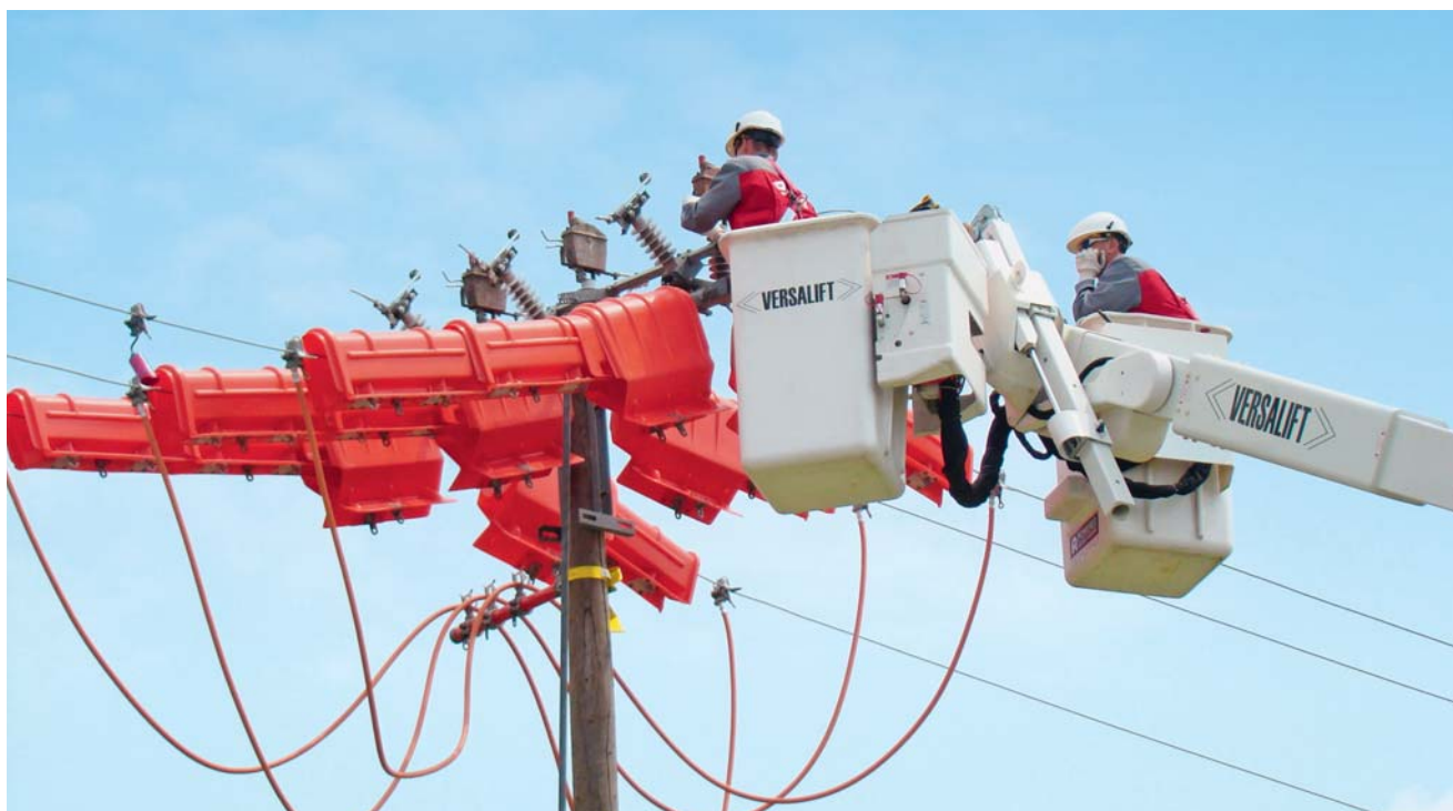
Kako se pod naponom (20 kV) održava linijski rastavljač pokazali su elektromonteri EON Network Services Ltd, Hungary
