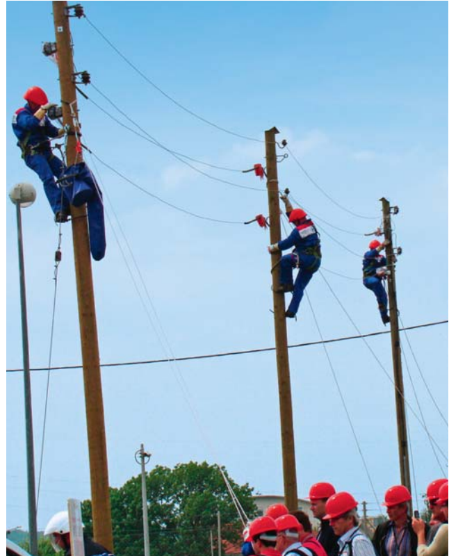
Elektra Zabok, koja na niskom naponu svakodnevne poslove obavlja pod naponom, u TS Žerjavinec je demonstrirala rekonstrukciju neizolirane mreže SKS-om
