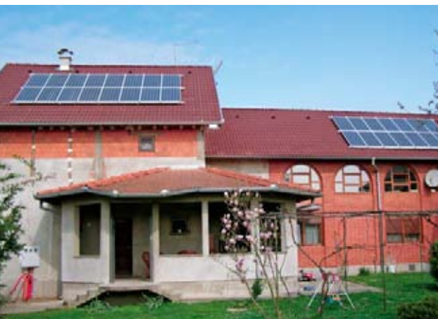
Sunčeva elektrana (FnE moduli) u Sikirevcima, priključne snage 10 kW, izgrađena na krovu stambeno-poslovne zgrade
