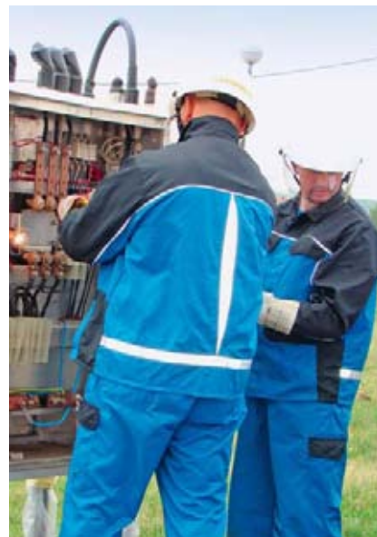
Reviziju razvodnog ormara - pod 0,4 kV naponom - pokazali su elektromonteri NE Krško
