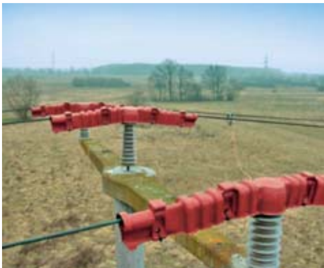
Na stupu su izolacijske kape na potpornim izolatorima, postavljene za zaštitu ptica od strujnog udara
