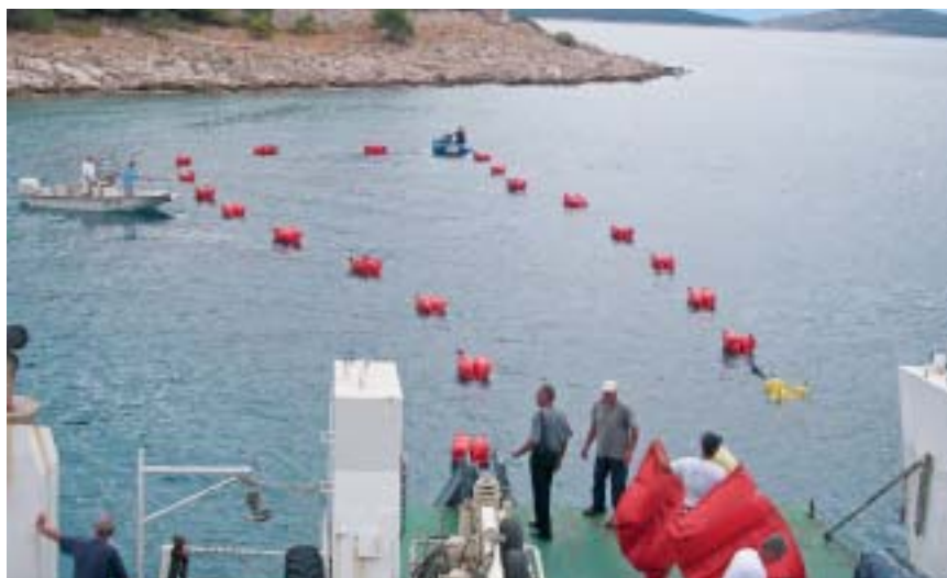
Polaganje je okončano, u mirnoj završnici kabel je na kušinima doplivao do Zlarina
