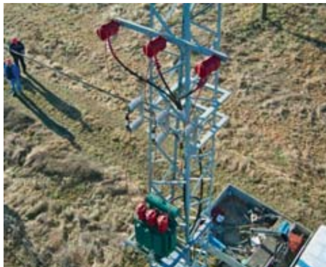
Svi dijelovi pod naponom stupne trafostanice, s kojima bi ptica ili mala životinja mogla doći u dodir, izolirani su posebnim materijalom
