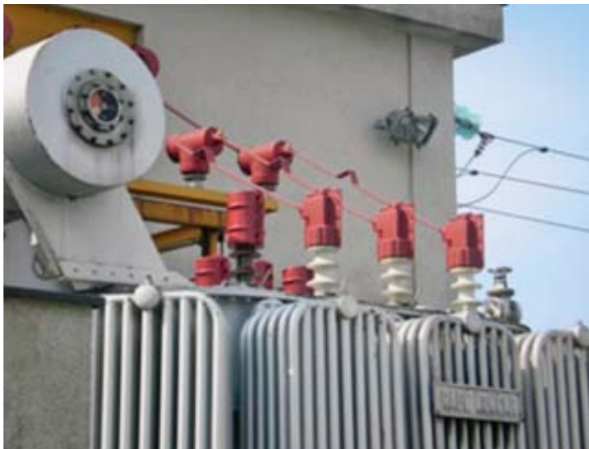
Zaštita ptica od strujnog udara u TS 35/10 kV provedena je izoliranjem sabirnica i priključaka transformatora
