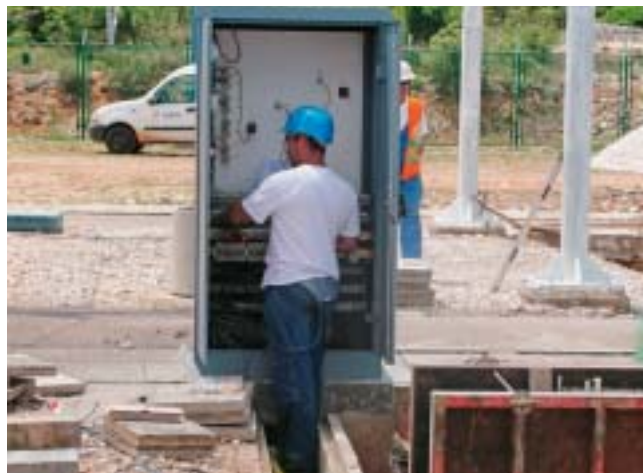
U rekonstruiranim vodnim poljima obavljena je zamjena opreme i ožičavanje upravljačkih ormara
