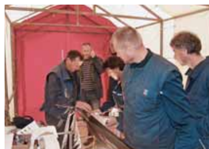
Stručnjaci Odjela građenja na sredini trase izrađuju kabelske spojnice, zbog kiše, u šatoru
