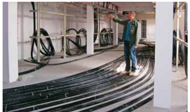
U kabelskom odjeljku unutar TS Dugopolje, A. Batarelo pokazuje kamo će se kabeli uspeti prema ulazu u BVK postrojenje
