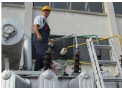
Kruno Vidaković, zadužen za osiguranje mjesta rada prije mjerenja otpora izolacije namota energetskog transformatora 35/10 kV u TS 110/35/10 kV Osijek 2
