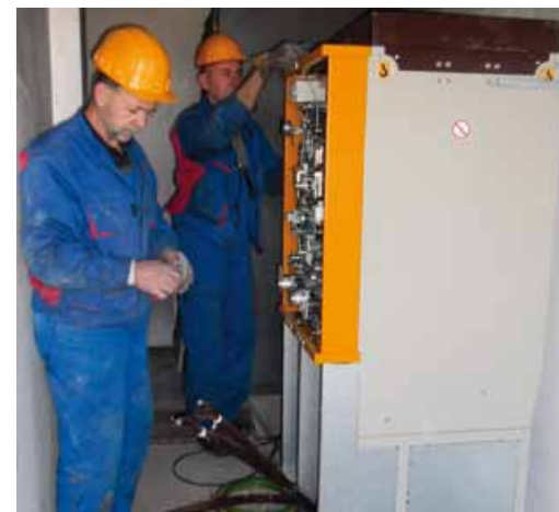
Privremeno srednjonaponsko postrojenja u transformatorskoj stanici Đakovačkoga vodovoda poslužit će dok ne stigne novo
