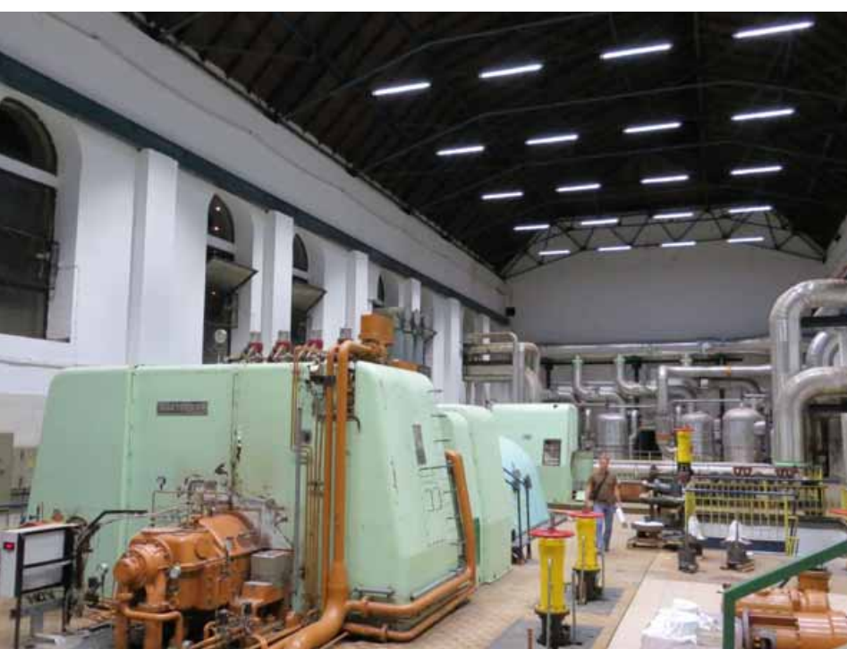
Unutrašnja LED rasvjeta strojarnice turboagregata 1 i 2
