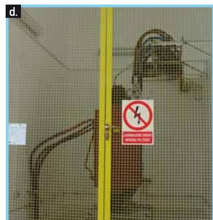
c. Uljni transformator vlastite potrošnje, star više od 40 godina, uskoro će u zasluženu mirovinu
