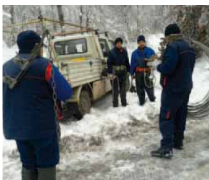
Ekipa montera Pogona Ozalj Elektre Karlovac pod punom radnom spremom kreće na trasu dalekovoda
