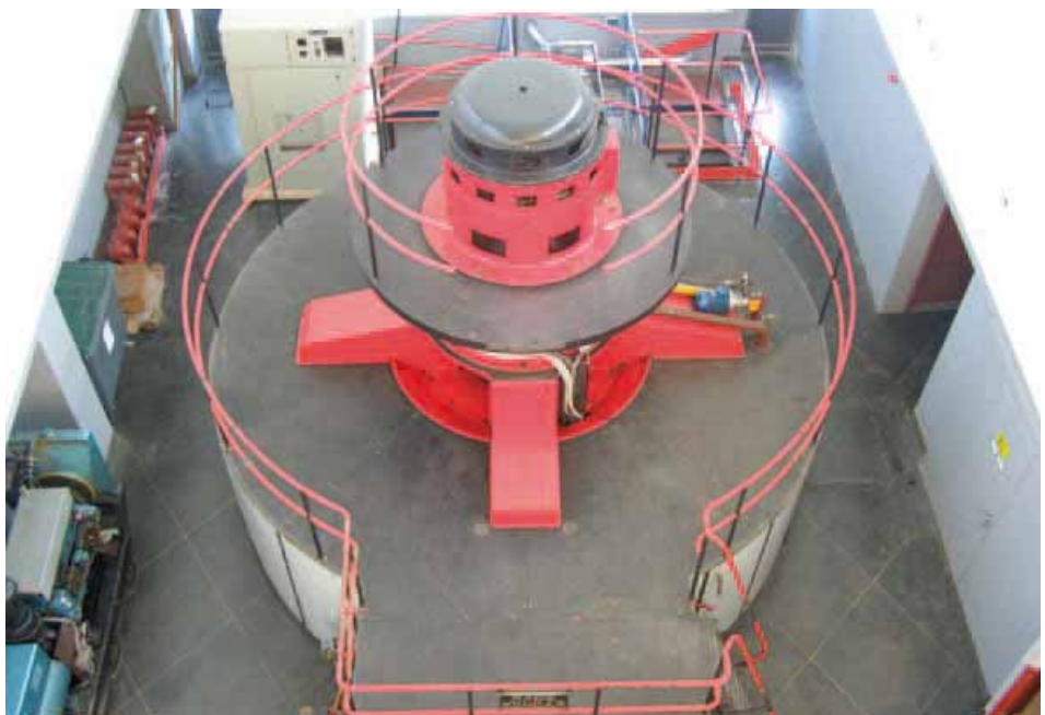
Motor-generator crpno-turbinskog agregata u CHE Fužine iskazao se kada je bilo najpotrebnije
