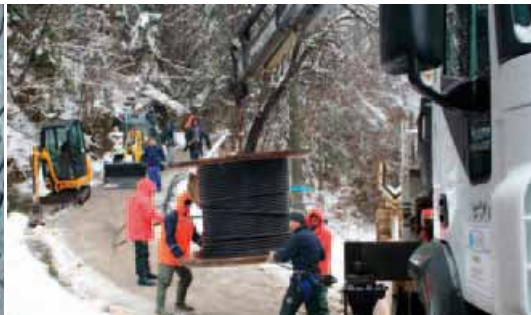
Kabeli 20 kV razvlače se privremeno po zemlji, samo da se Gorani što prije napoje električnom energijom
