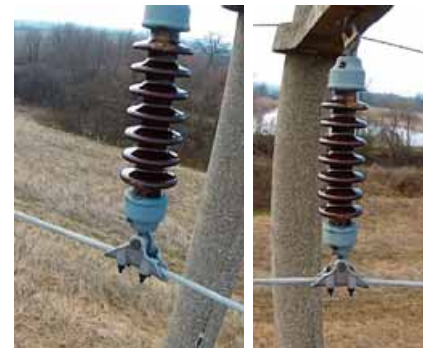
Snimke Phantoma 2 (iz različitih kutova), na kojima se vide oštećenja izolatora na betonskom stupu
