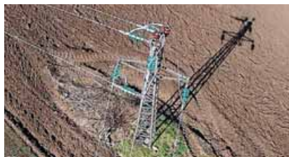
Čeličnorešetkasti dalekovod na području Erduta, snimljen Phantomom
