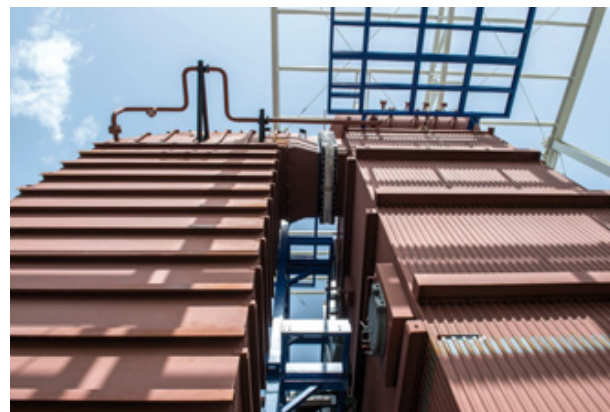
Kotao: ovdje se energija dimnih plinova prenosi na vodu, koja prelazi u paru i služiti će za zagrijavanje vrelodnog sustava Osijeka ili za potrebe industrije
