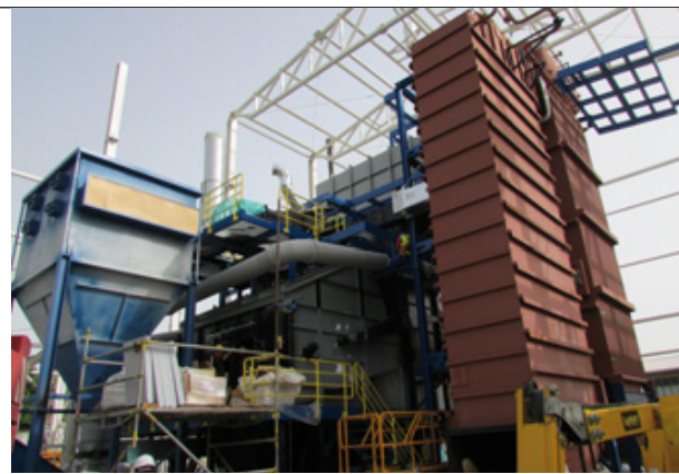
Montirano je ložište, kotao i visoko temperaturni ekonomajzer , a radi se na montaži puhača čađi te gazišta i ograda za hodanje oko bojlera
