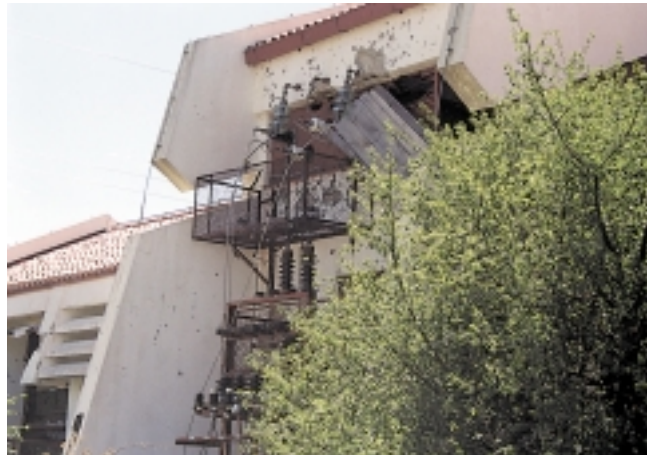
Trafostanica 35/10 kV vapi za obnovom
