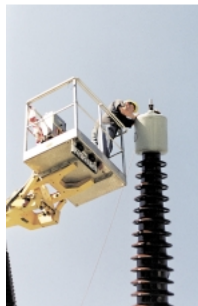
Okom kamere uhvatili smo i radove prenošača na pripremi ispitivanja transformatora 400/110 kV
