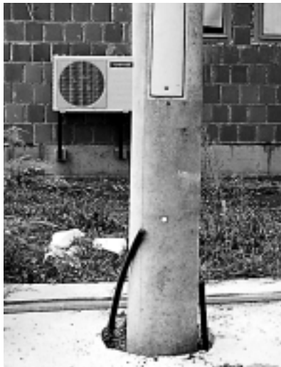
... najnoviji za javnu rasvjetu u podzemnoj kabelskoj izvedbi, s razvodnom kutijom za spajanje kabela
