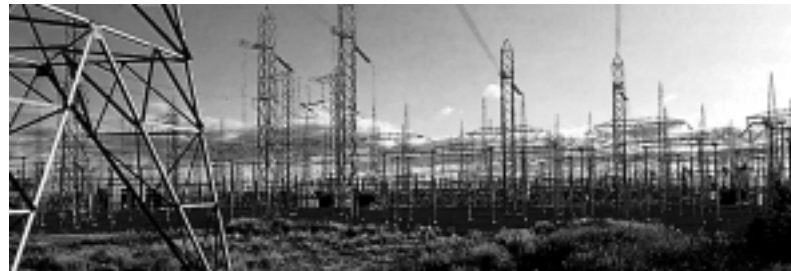
Trafostanica Arnaud izgrađena za Hydro Quebec u Kanadi može raditi na temperaturama nižim od 50 stupnjeva C
