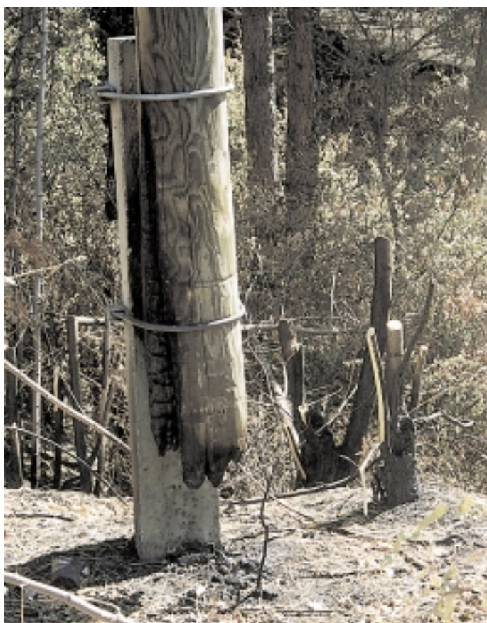
Požar je krenuo 10 metara dalje od našeg čelično-rešetkastog stupa
