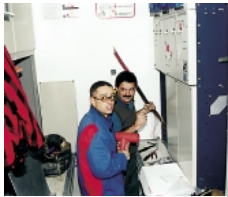
Željko Kraljevac i Željko Erdeš pripremaju postrojenje TS za napon
