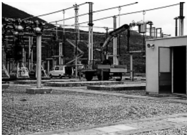
Revizija opreme glavnih sabirnica 400 kV u TS 400/220/110 kV Melina (rastavljači GS)
