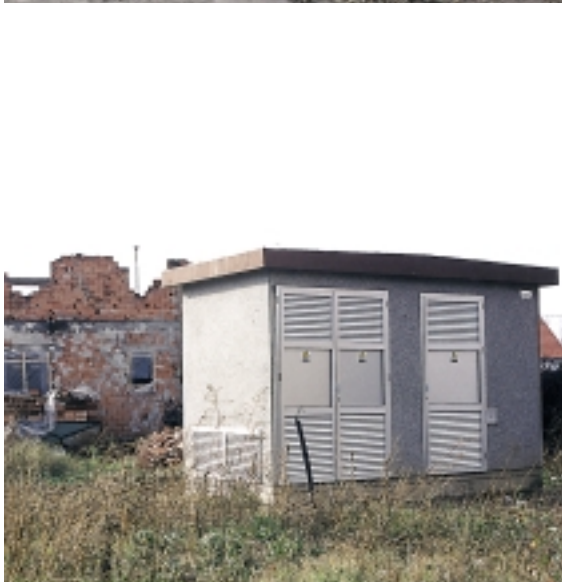
TS 10/0,4 kV na Mitnici još ne zuji
