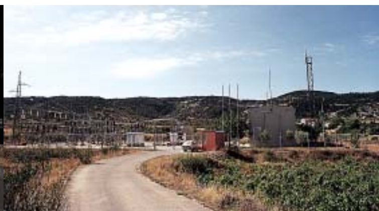
TS 110/35 kV Nerežišća
