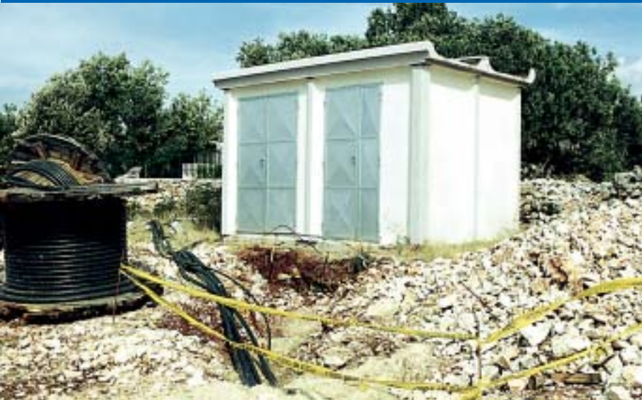
Jedna od četiri sevidske trafostanice koje će krajem listopada biti puštene u rad
