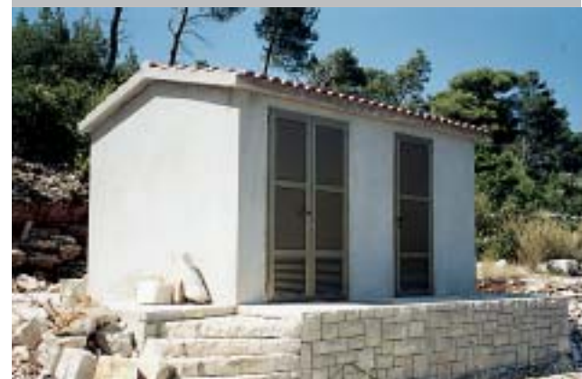
TS 10(20)/0,4 kV Naplovac - zgradu su izgradili mještani prema tipskom projektu još prije godinu i pol dana, čeka se oprema
