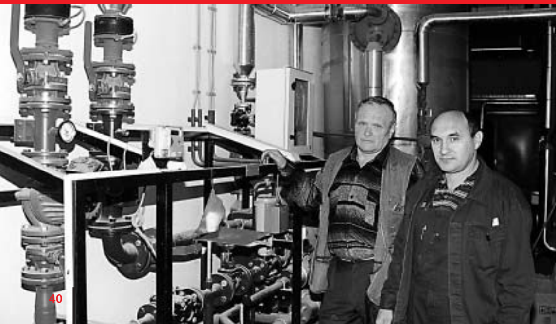
Tzv. kompaktna toplinska stanica: manje prostora, više automatizacije
