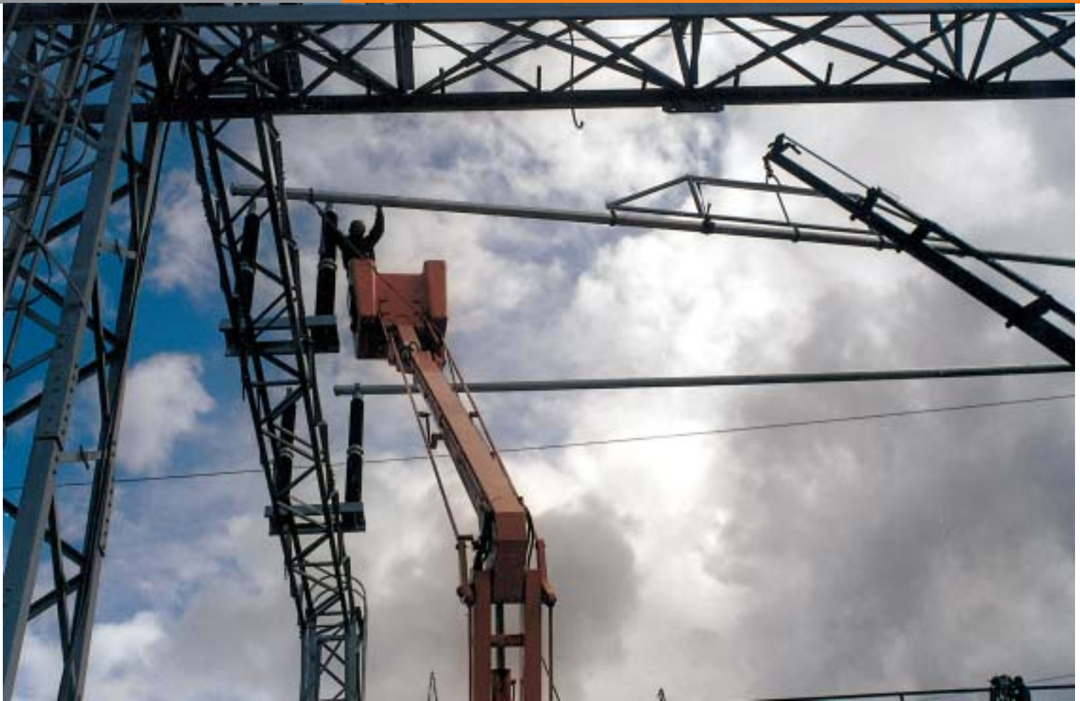
Sabirnica je gore bliže kišonosnim oblacima koji ne raduju izvođače radova iz tvrtke Končarev Montažni inženjering, ali što je - tu je
