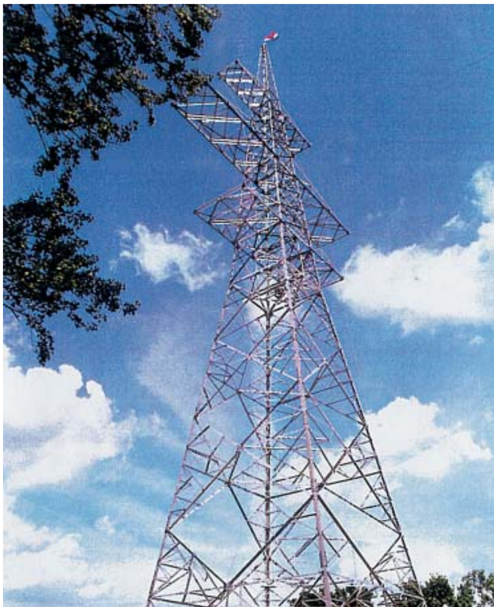
DV 2 x 400 kV Heviz - Žerjavinec: hrvatski granični stup - prijelaz preko rijeke Mure
