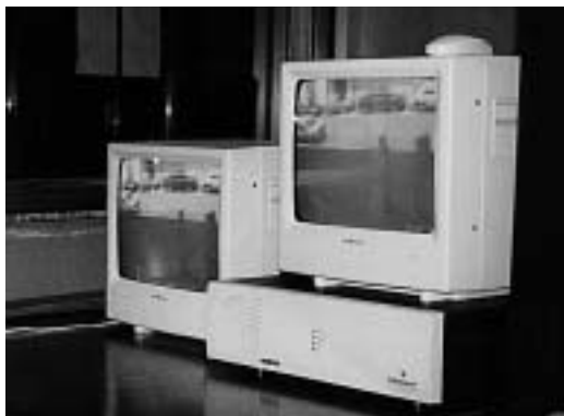
Na ovim monitorima nadziru se ulazi u zgradu sjedišta DP Elektroprimorje te događaji u prostoriji za potrošače
