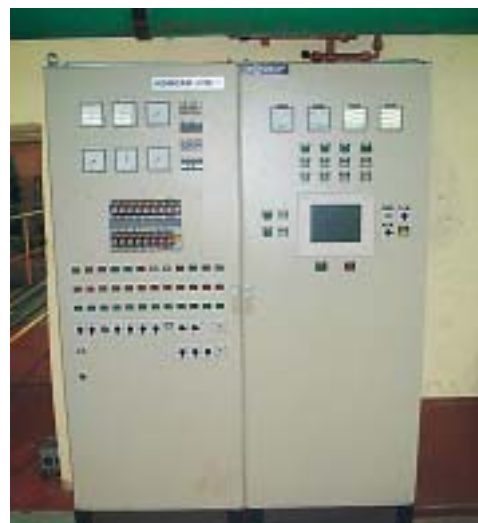
Novi upravljački ormari
