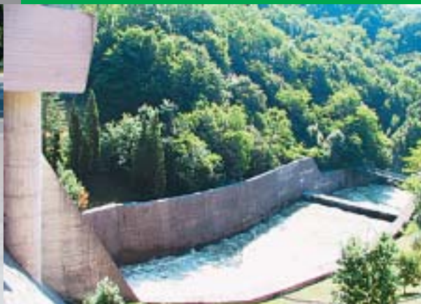
A, voda iz akumulacije kontrolirano otječe prema koritu Rječine
