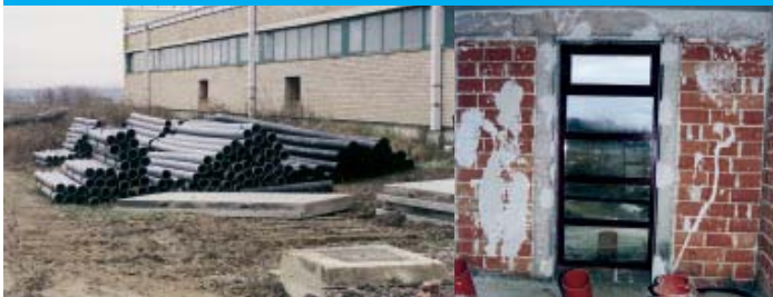
Cijevi za kabelsku kanalizaciju
