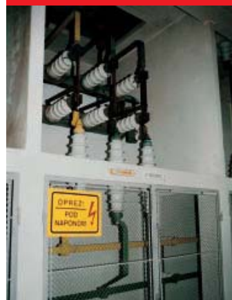
Osigurači u 35 kV postrojenju smještenom u zgradi sada već "muzejski primjerci"
