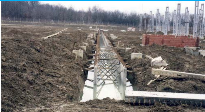
Kabelski kanal u postrojenju 400 kV opet je potopljen
