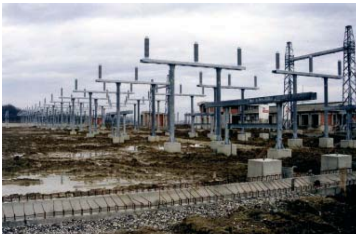
Montirani potporni (silikonski) izolatori (proizvođač Končar - EVA) u postrojenju 110 KV
