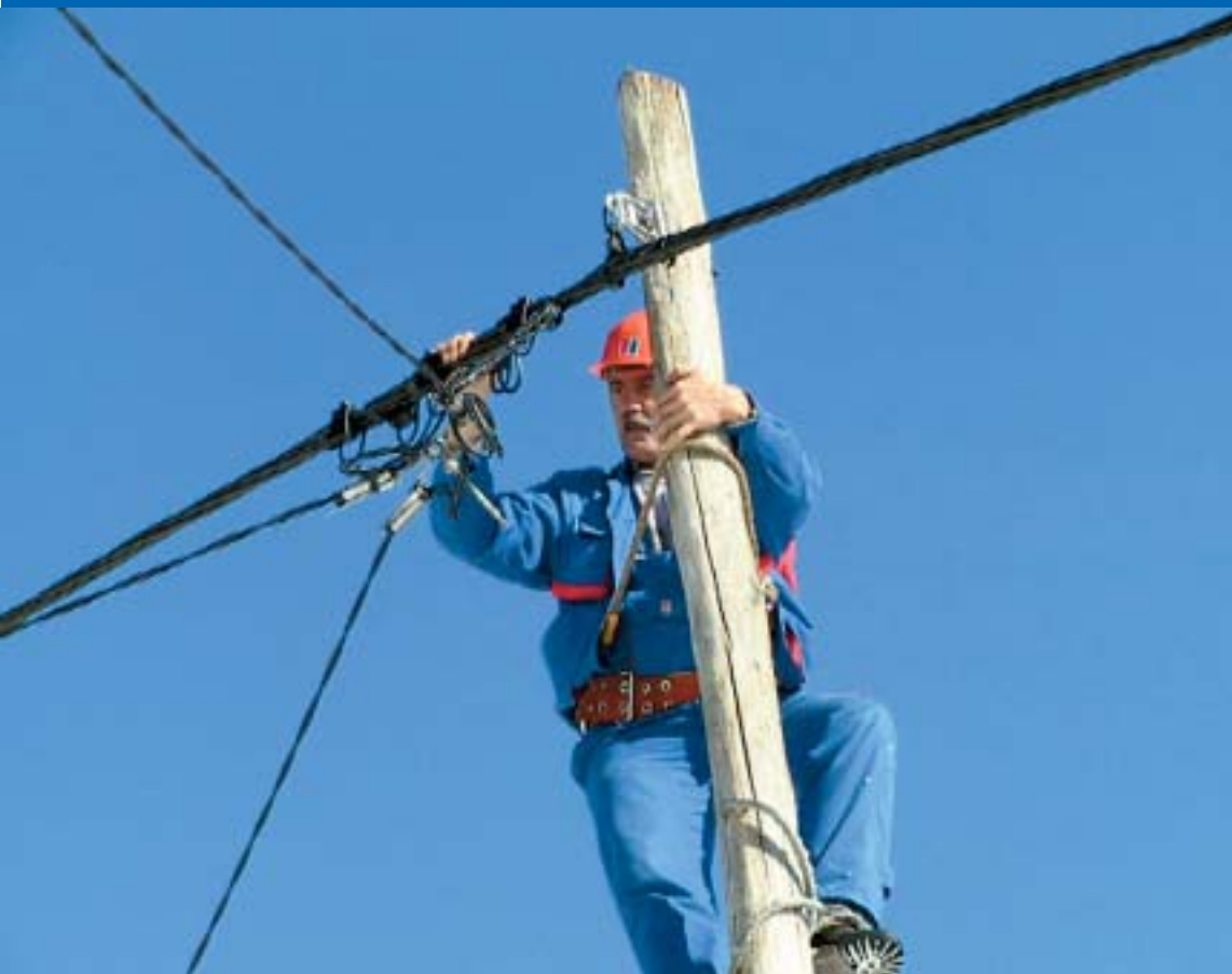
Kvar na stupu, ali u kratkom trenutku Mario Janeš je gore. Još jedan časak i kvar je otklonjen. A snijeg? U Gorskom kotaru snijeg je normalna pojava
