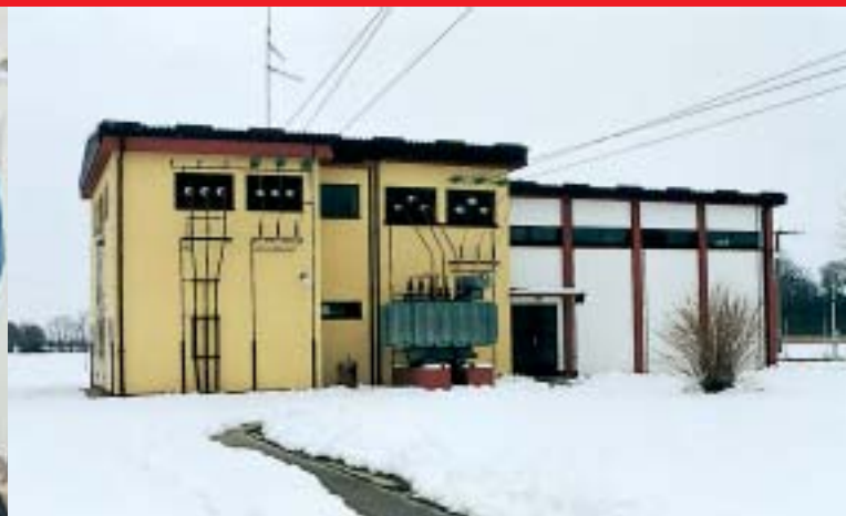
TS 35/10 kV Prelog prošle je godine dobila novu fasadu i krov, a ovdje su izolirane 35 i 10 kV sabirnice
