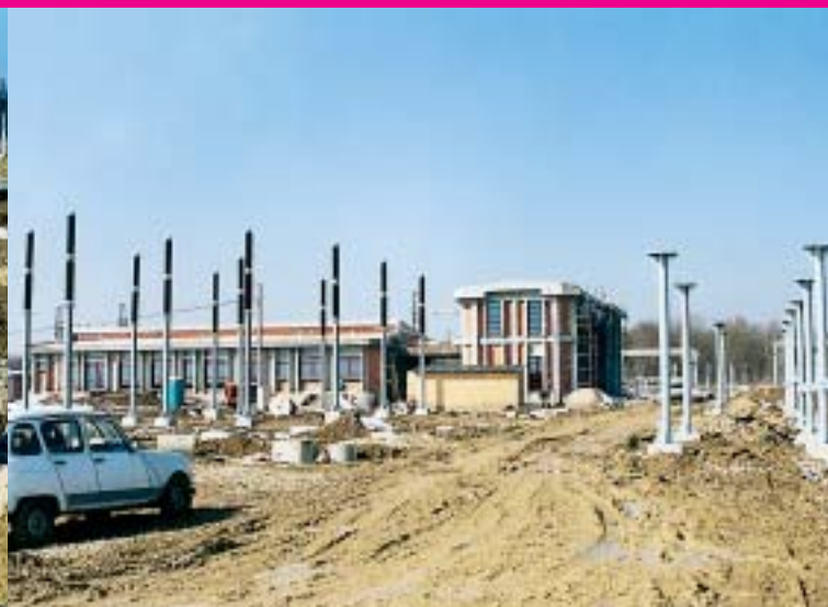
Postolja aparata i montirani potporni izolatori u postrojenju 400 kV
