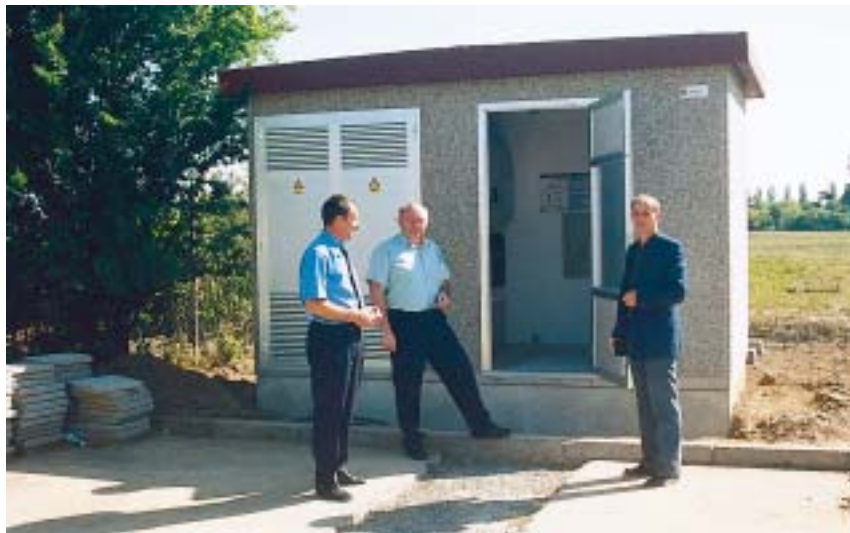
Novoizgrađena TS 10/0,4 kV u Zračnoj luci Osijek, pokraj koje će zbog dodatne sigurnosti biti postavljen i agregat za samouključenje
