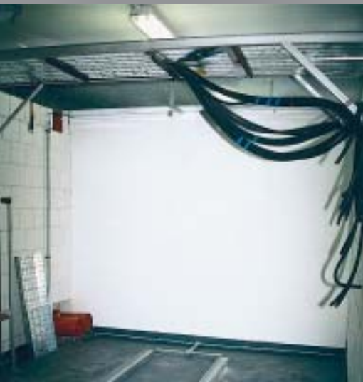
Jedna od četiri pripremljenih komora za smještaj transformatora
