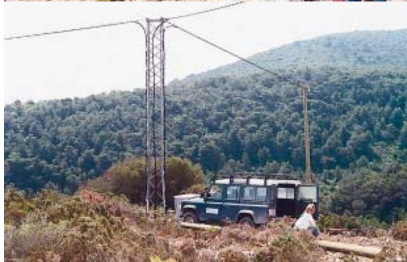
Prvi put u zraku 20 kV kabel, na stupu su jedan dovod i dva odvoda
