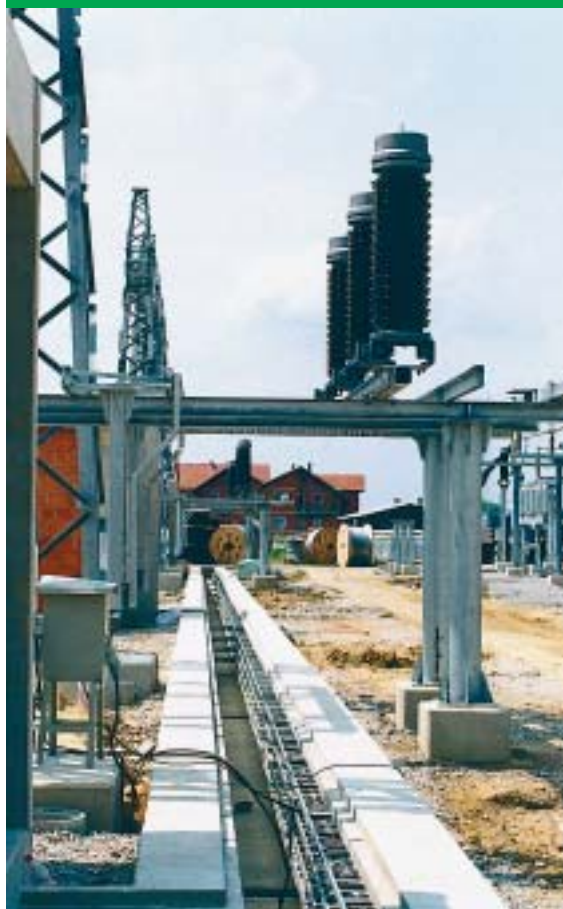
U RP 110 kV montirani su i mjerni naponski transformatori
