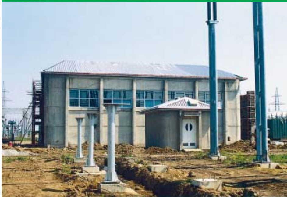
Obnovljena zgrada srednjeg i niskog napona
