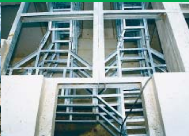
Rasplet polica za kabele na spoju uzdužnih i poprečnih kabelskih kanala snimljen iz ptičje perspektive
