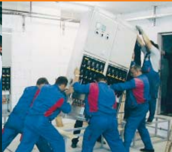
Ručno unošenje niskonaponskog razvoda
