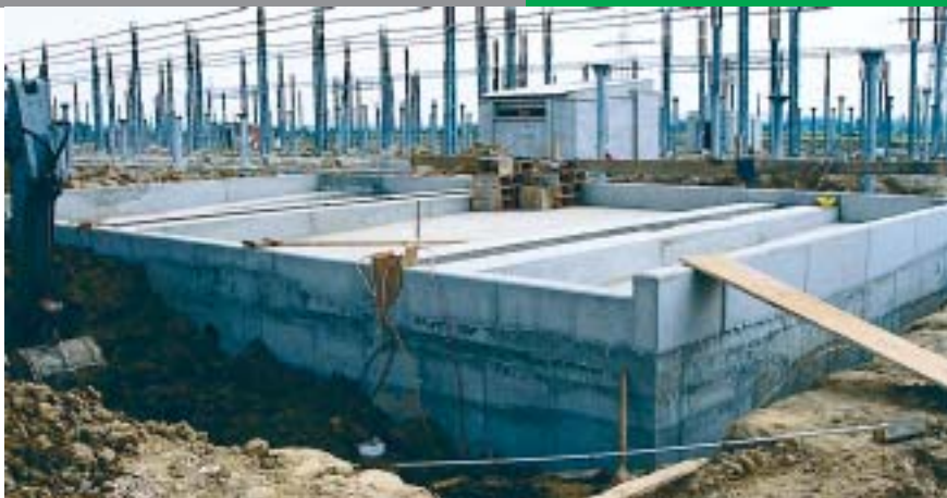
U temelj za transformator TR 1 u RP 400 kV ugrađeno je približno 320 kubičnih metara betona i 22.000 kilograma armature
