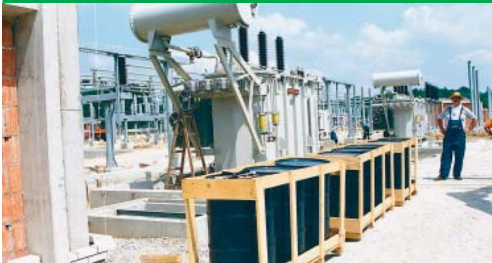
Montirana su dva energetska transformatora 20 MVA 110/20(10) kV (TR 6 i TR 7), a stigle su i bačve s trafouljem
