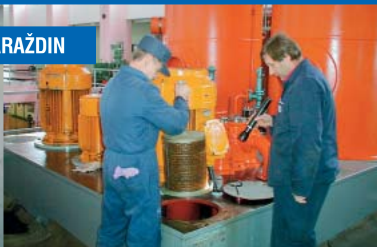
Na redu je turbinska regulacija
