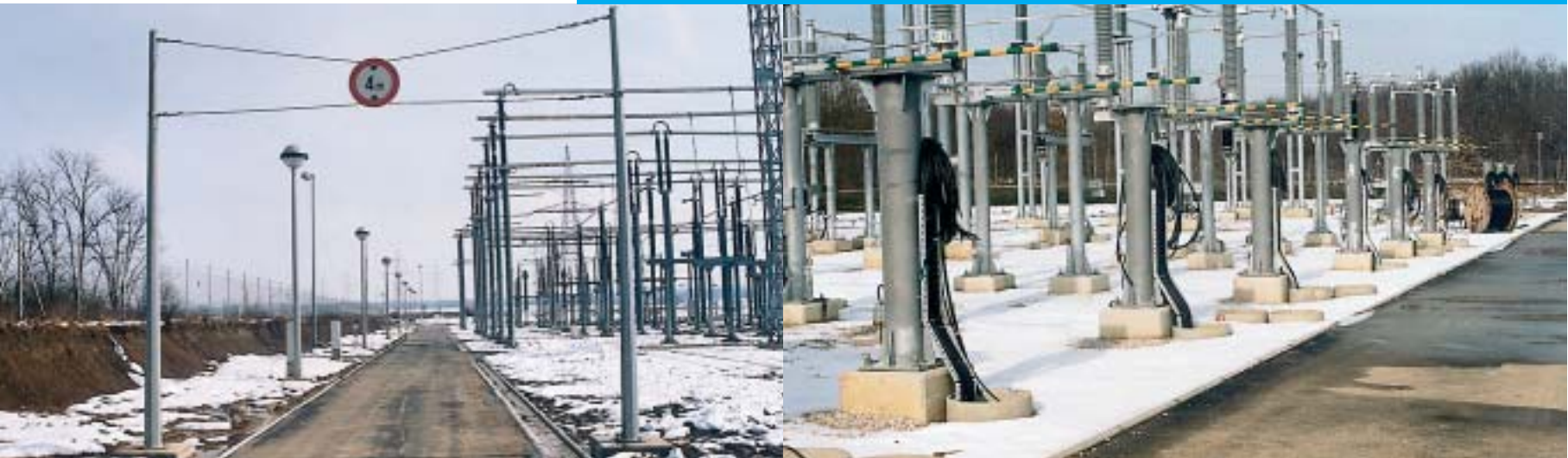
Postavljen je i graničnik visine na prometnici u RP 400 kV
