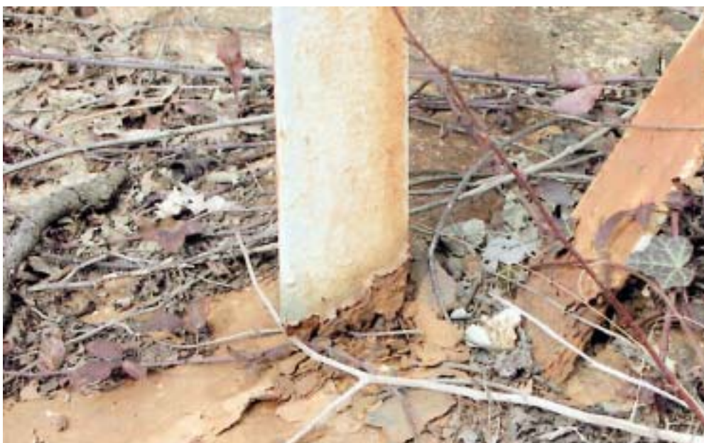
"Noga" (bočnice) rešetkastog stupa izjedena hrdom
