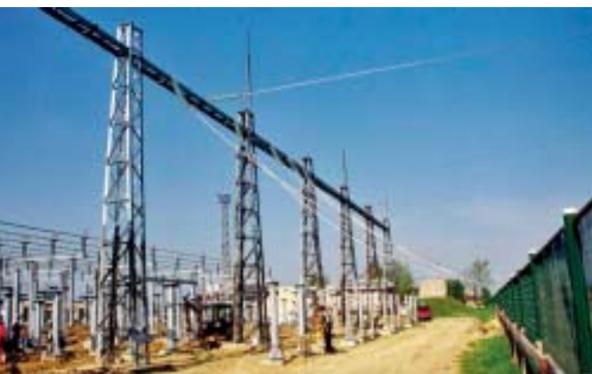
Priključak dalekovoda na izlazne portale
