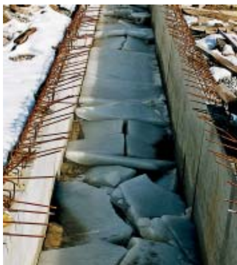
Led je zarobio kableske kanale
