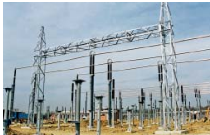
Portal za prihvat 400 kV vodova
