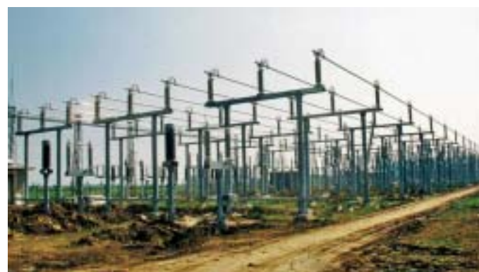
Rasklopno postrojenje 110 kV
