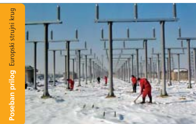
Uzemljenje čelične konstrukcije nosača sabirnica 110 kV
