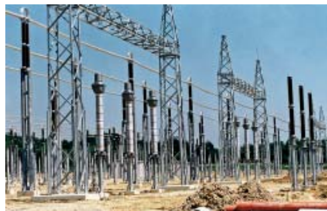
Strujni i mjerni transformatori u 400 kV rasklopnom postrojenju
