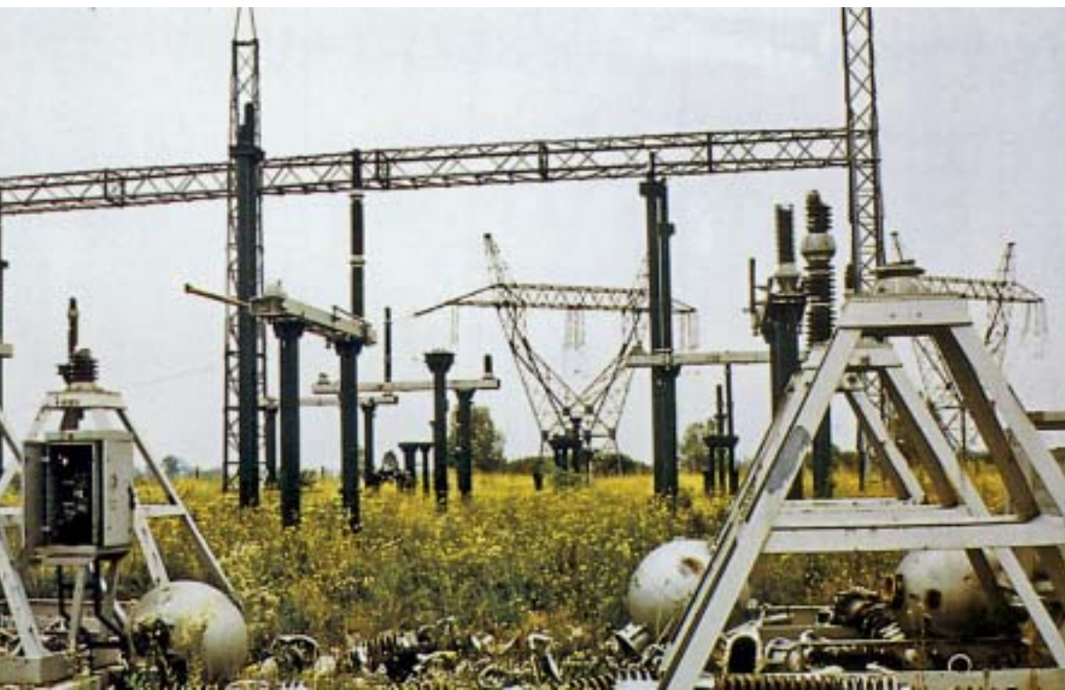
Ostaci prekidača 400 kV
