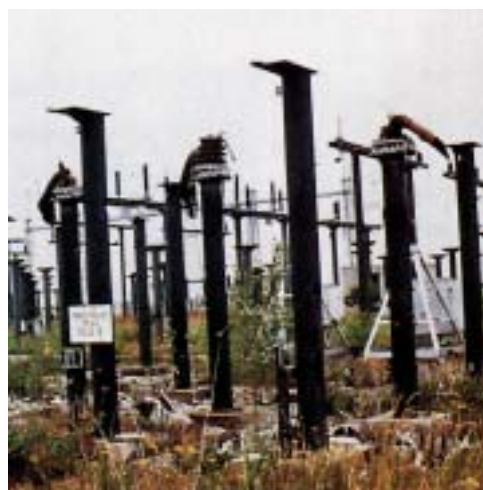
Trafo polje 110 kV
