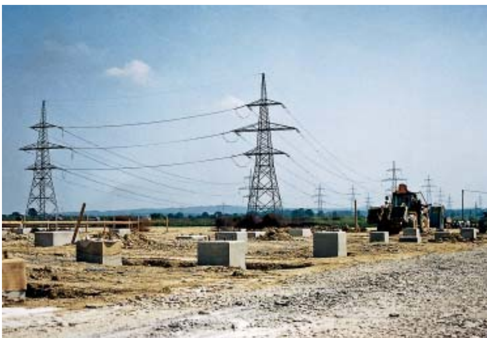
Temeljni aparata na 400 kV strani
