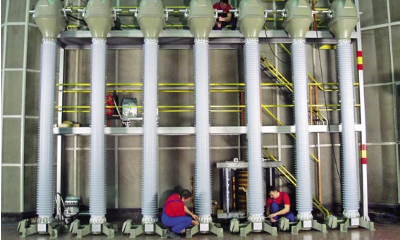
Strujni mjerni transformatori 400 kV (silikonski izolatori)
