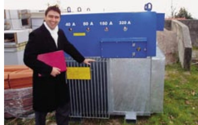
Novo automatske kompenzacijske prigušnice, prve takvoga tipa u Hrvatskoj, čekaju na ugradnju
