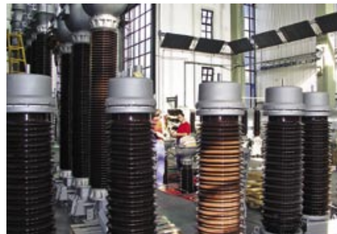
Ovdje se proizvode i montiraju transformatori
