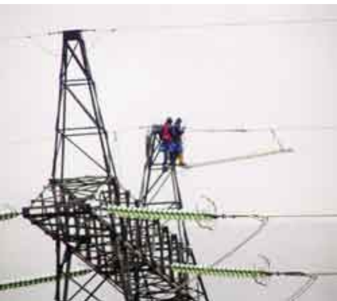
Postavljanje OPGW kabela na trasi DV Konjsko - Mostar (do granice s BiH)
