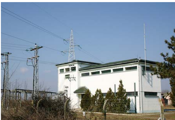
U Baranji je posljednja obnovljena TS Kneževi Vinogradu
