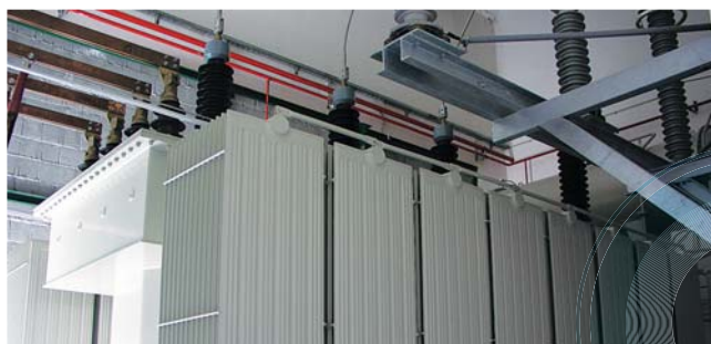
Novi transformator popunio je desetogodišnju prazninu komore 1
