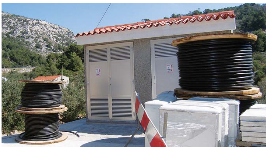
Nova trafostanica 10(20)/0,4 kV U Milni
