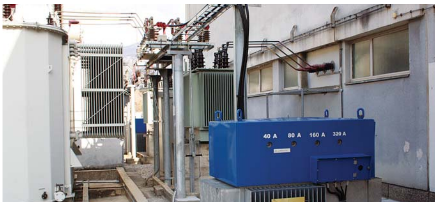
Ovako izgledaju automatske kompenzacijske prigušnice ugrađene u Crikvenici
