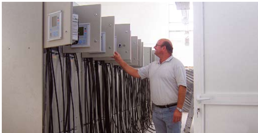
Boris Bašić, rukovoditelj Pogonskog ureda Biograd u novom 10 kV postrojenju u TS 110/10(20) kV Biograd, gdje su građevinski i elektromontažni radovi pri završetku i krajem godine trafostanica će krenuti u svoj novi život
