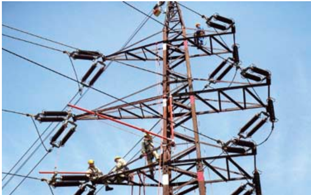
Poljski tim mijenja dvostruki zatezni izolatorski lanac na vodu 110 kV pod naponom, a na istom stupu tim Siemens mijenja zaštitno užje i postavlja OPGW
