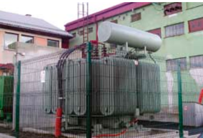
U TS 35/10 kV Zlatar Bistrica, jednoj od najstarijih u Elektri Zabok, prošle su godine zamijenjena dva stara transformatora od po 4 MW sa dva nova od 8 MW
