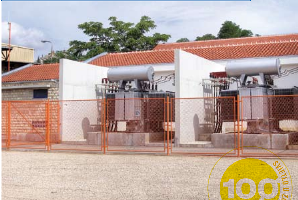
Transformatorski dio nove TS 35/10(20) kV Knin
