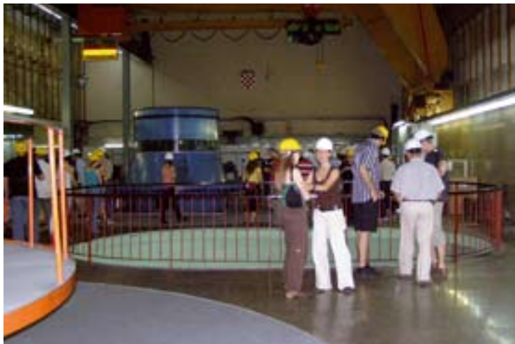
Budući energetičari u bliskom susretu s agregatima u strojarnici HE Zakučac
