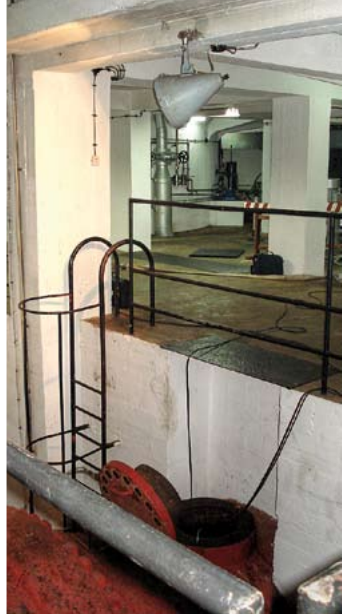
Ulaz u spiralu turbine A u strojarnici
