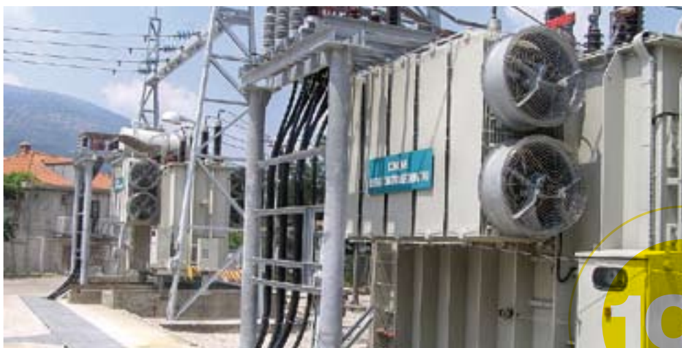
Priključak 35 kV kabela na energetske transformatore 110/35 kV
