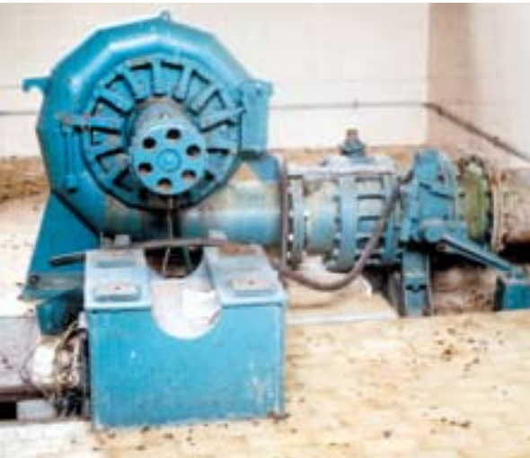
Strojarnica male hidroelektrane 38 kVA, 220/380 V na lokaciji SRC "Rade Končar" na Zvečevu - s turbinom, ali bez generatora kojeg je netko otuđio
