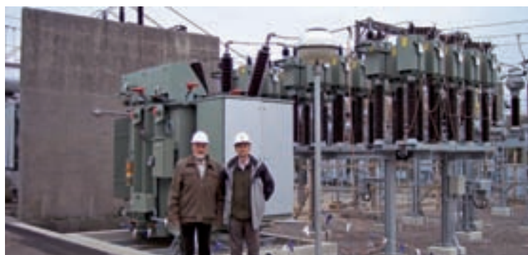
MTU filtersko postrojenje
