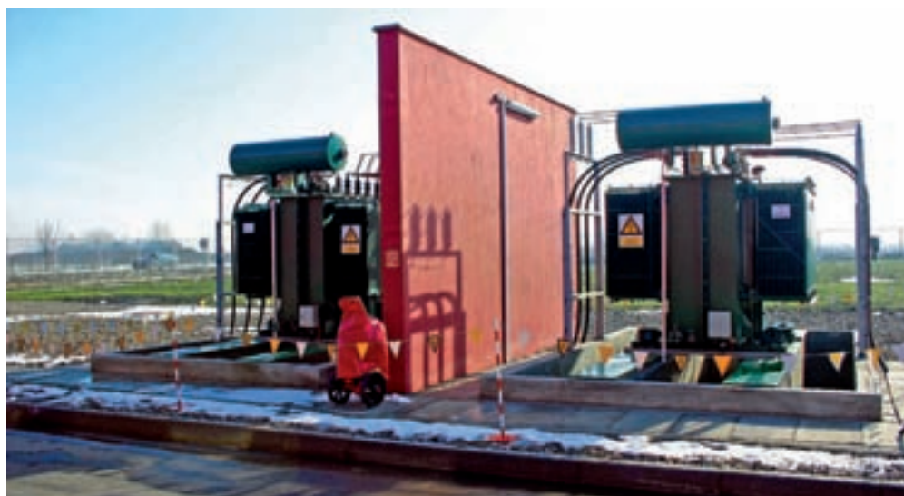
Novo transformatorsko postrojenje
