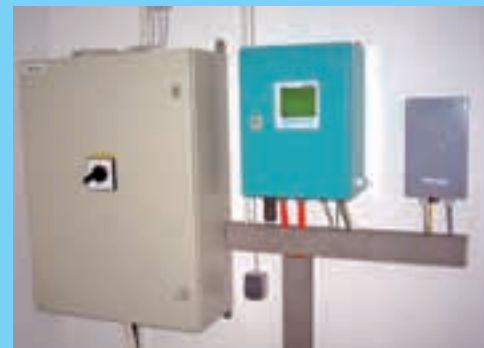
Ormarčić ultrazvučnog nadzora tlačnog cjevovoda na DMM
