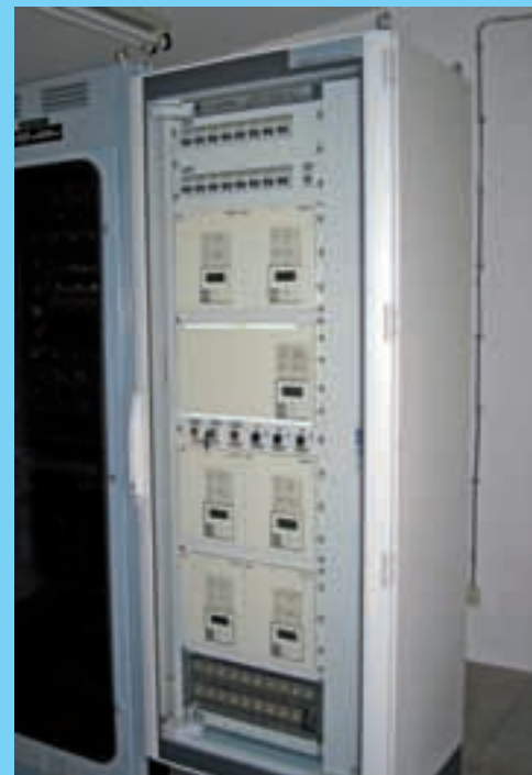
Ormar zaštite sabirnica i zaštite od zatajivanja prekidača 400 kV postrojenja
