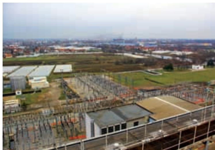
Pogled na adaptirano rasklopno postrojenje 110 kV
