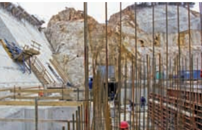
Prostor aneksa strojarne u kojemu će biti smješteni svi prateći sadržaji, poput uljnog gospodarstva, prostora za akubaterije, skladišta, radionice, sanitarni čvor, svlačionice...
