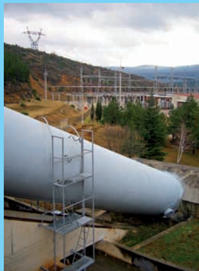
Ugrađena oprema ultrazvučnog nadzora tlačnog cjevovoda
