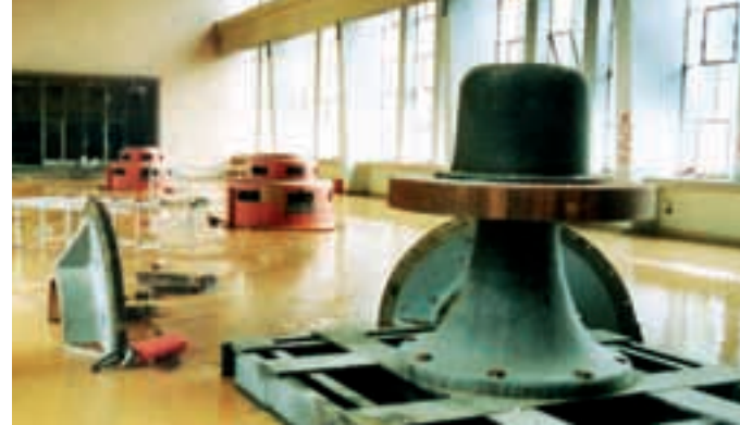
...strojarnica Hidroelektrane Peruća...
