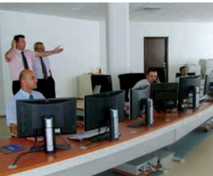
Tri radna mjesta s tri ekrana opslužuju Dispečerski centar u vodenju elektro-prijenosnog sustava u realnom vremenu
