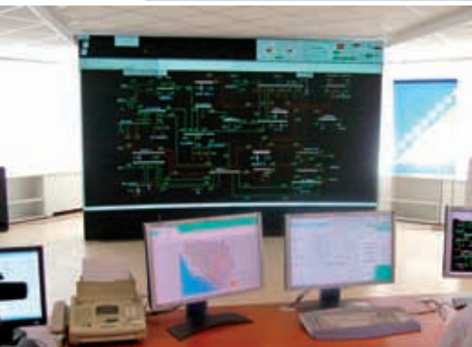
Video zid (3 X 4 ekrana) na kojem je prikazana 220 i 400 kV prijenosna mreža
