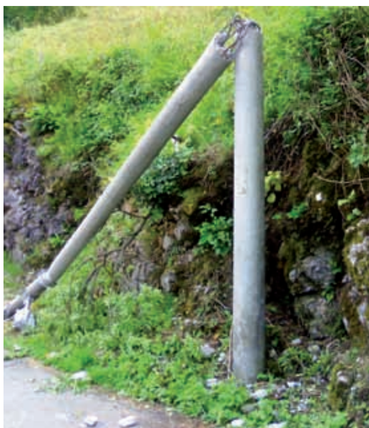
...slomljene betonske stupove...
