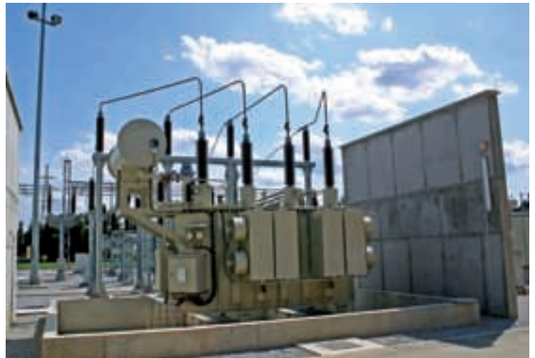
Transformator u TS Osijek 4 pod naponom je od 17. srpnja!
