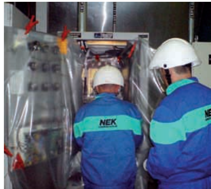
Stručna praksa u NE Krško - otklanjanje pogreške na inverteru - pod naponom
