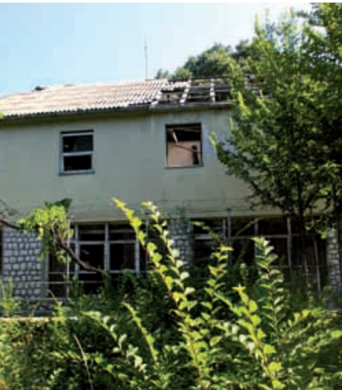
Objekt za odmor HEP-a u Biogradu stradao je u razaranjima tijekom Domovinskog rata i od tada propada
