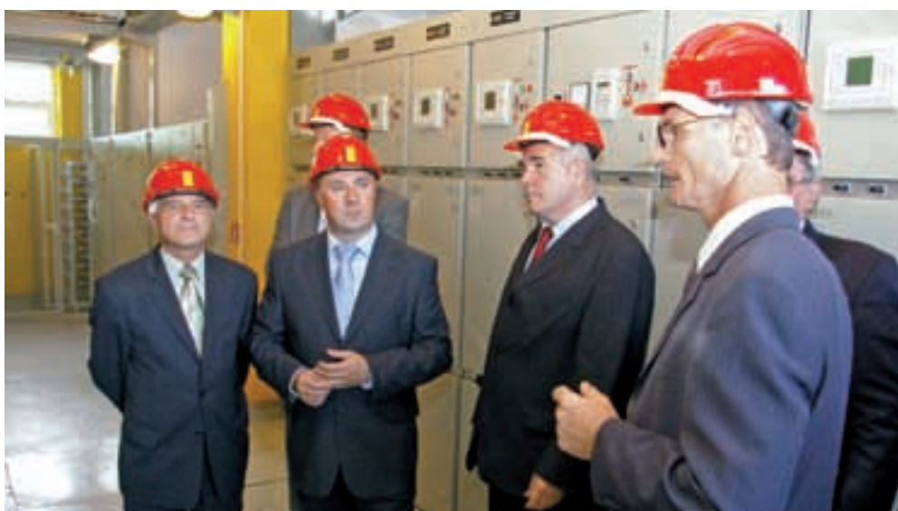
Direktor Elektre Koprivnica Ivan Gregur je, prigodom obilaska postrojenja, visoke uzvanike upoznao s načinom rada trafostanice
