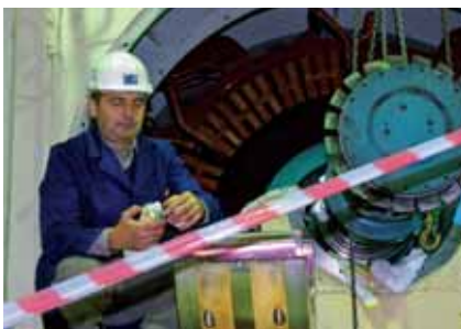
Stručnjaci Ekonerga ispituju ležajeve generatora
