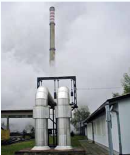
Polazni vrelovod iz TE-TO Zagreb
