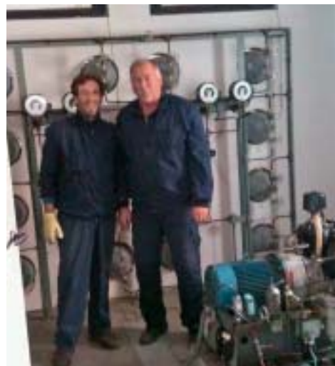
Cjelokupnu demontažu i elektromontažne radove pri zamjeni prekidača 110 kV u DV poljima Zadar i Benkovac obavili su zaposlenici Odjela za TS PrP-a Split
